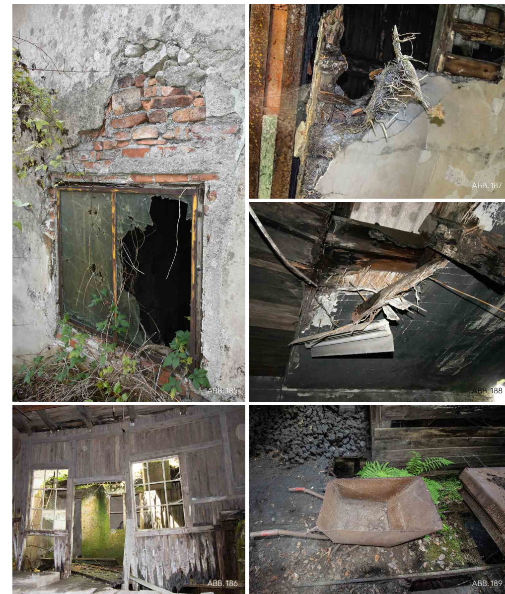
ABB. 185: Kaputte Fensterscheibe aus Drahtglas, Rostender Fensterflügel. Freigelegtes Mauerwerk außen.
