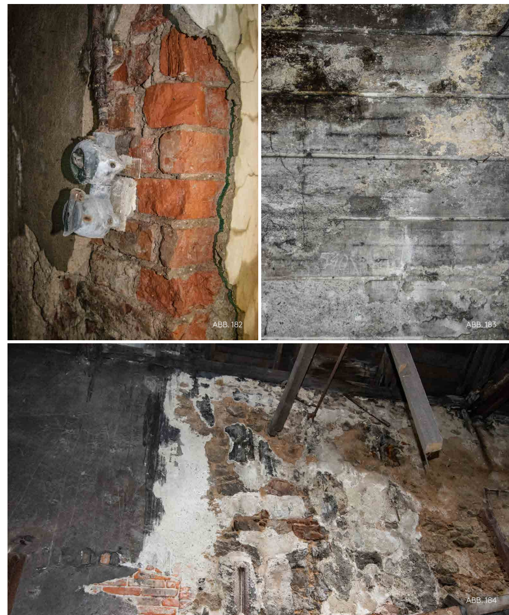
ABB. 182: Großflächige Putzabplatzung im Bereich eines Lichtschalters
