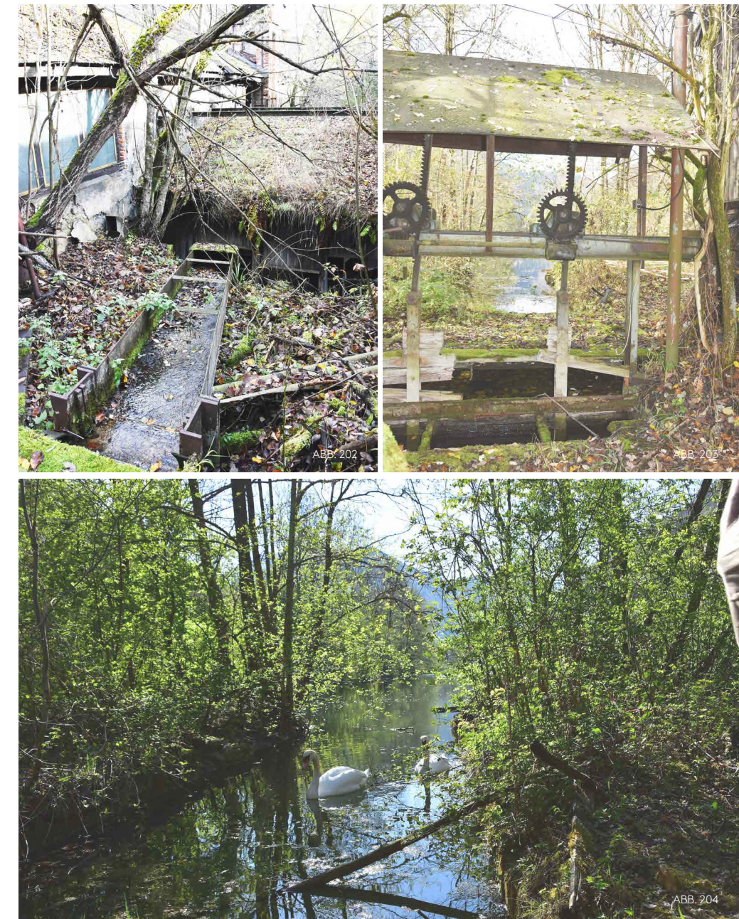
< ABB. 202: Gelenkter Wassereinflauf von Teich, Winter ^ ABB. 203: Blick Richtung Zwischentrakt mit geführtem Wasserabfluss von Wehr, Winter ^ ABB. 204: Blick von Wehr zu Werksteich, Sommer
