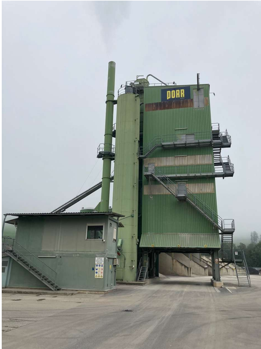
Abb. A.20: Mischanlage Mürzzuschlag (Mischturm und Waage)
