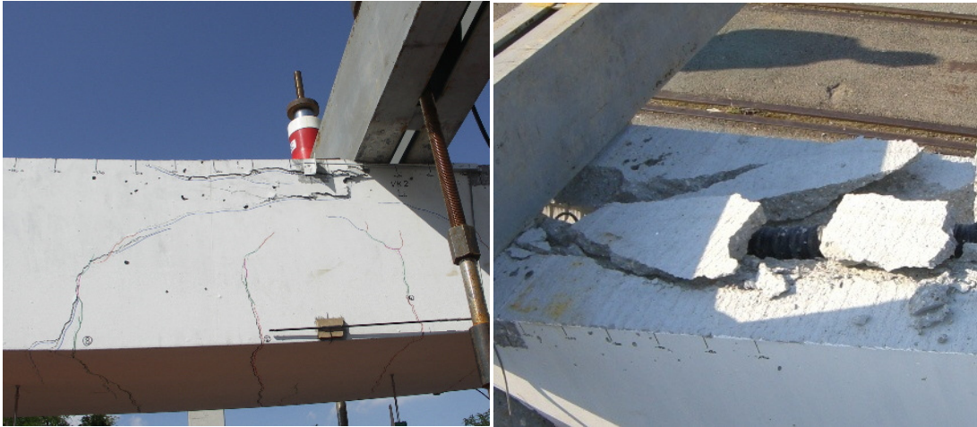
Abbildung 10.7: VK2 – Abplatzungen der Betondruckzone im Feld bei x = -2,5\text{m} vor dem Endversagen (links) und nach dem Endversagen (rechts)
