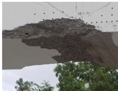
Abbildung 9.17: Unterseite des Bereichs über dem Mittelaufleger
