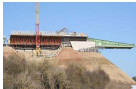
Abb. 14 Taktanlage mit Vorbauschnebel (STÖRFIX, 2006)
