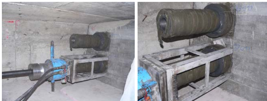
Abbildung 8.19: Links: Durchführung der Abhebekontrolle; rechts: Zeitpunkt Abheben des Ankerkörpers von der Ankerplatte
