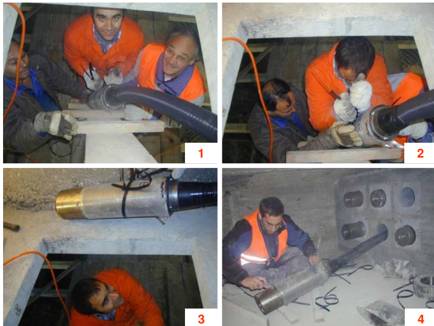
Abbildung 8.12: Einbringen der CFK-Spannglieder in den Hohlkasten (Bilder 1 - 3); Entfernen der Schutzfolie vom Ankerkörper und Aufbringen eines Korrosionsschutzes (Bild 4)
