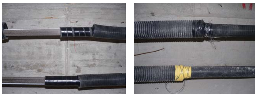
Abbildung 8.26: Schutz des CFK-Zugelementes; links: Kautschukeinlage mit Klebung; rechts: geschlossenes Hüllrohr (Klebung + Drahtverbindung beider Hüllrohrteile)
