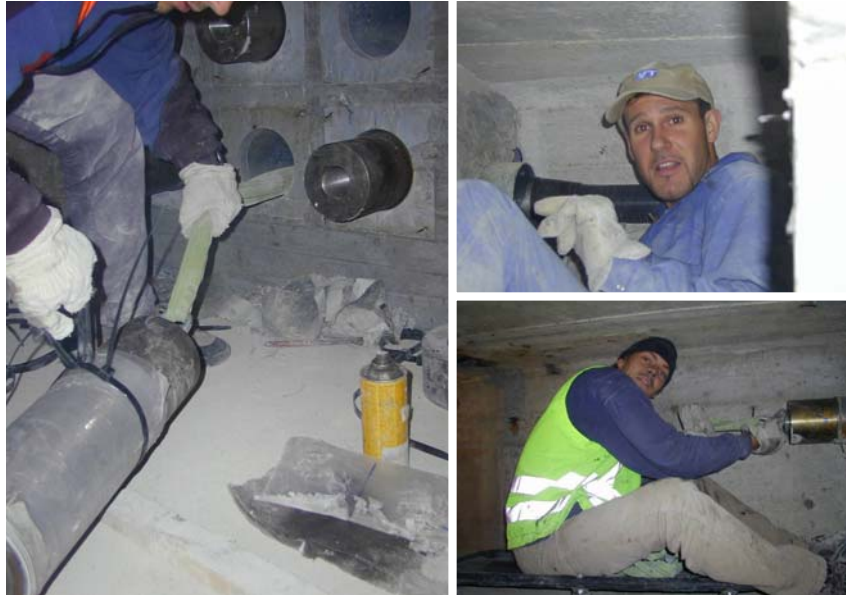
Abbildung 8.13: Links: Einfädeln des Spanngliedes in den Querträger 2003; rechts oben: Durchziehen des Spanngliedes zwischen den beiden Querträgern, rechts unten: Übernahme des Spanngliedes für den Transport zum gegenüberliegende Querträgerpaar
