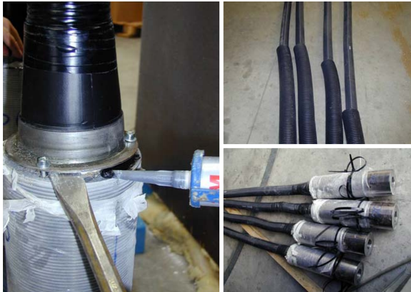
Abbildung 8.10: Links: Anschluss der Trompete, rechts oben: fester (kleiner Durchmesser) und beweglicher Teil des Hüllrohres; rechts unten: CFK-Spannglieder vor dem Aufrollen und Abtransport
