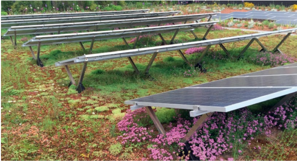
Abbildung 52: Kombination Gründach und PV-Anlage, (Brenneisen, Hanselmann und Lüthy, 2020, S. 1)
