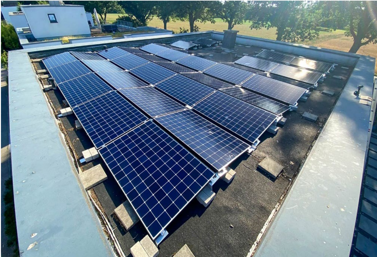
Abbildung 51: PV-Flachdach Ost-West, (Voltark GmbH, ohne Datum)
