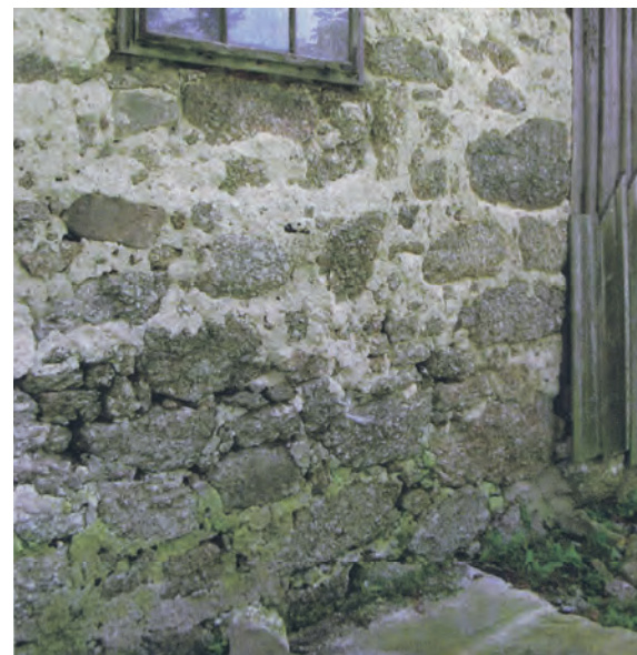
Abb. 98: Sockel einer Bruchsteinmauer mit Verdunstungszone
