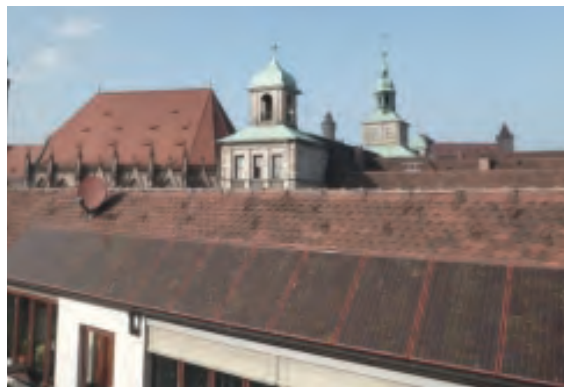
Abb. 123: dachintegrierte, durchgefärbte Photovoltaikanlage
