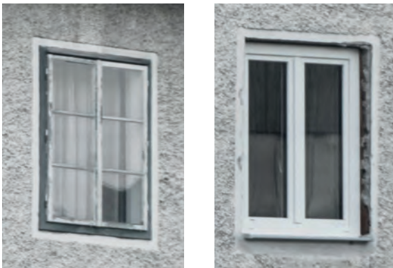
Abb. 117: Wohlproportioniertes Holzfenster (links) durch dichtes Kunststofffenster mit reduziertem Lichteinfall (rechts) ersetzt
