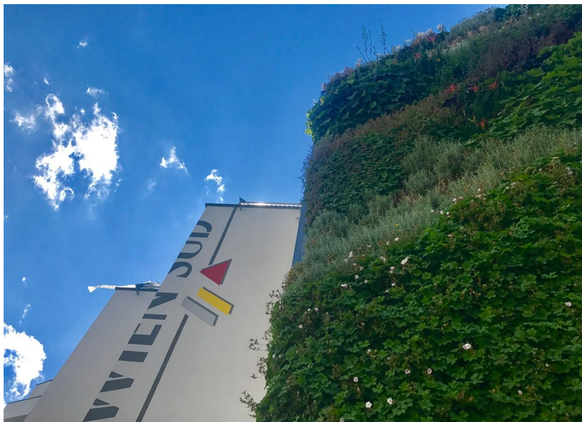
Abb. 71: Wittmayergasse 2 – Fassadenbegrünung System 90 DE GREEN® [LIC18]
