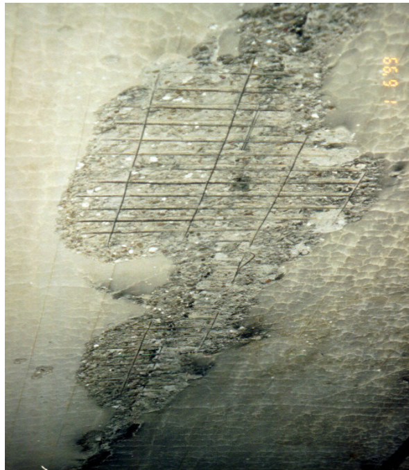
Abbildung 11: Zwischendeckenunterseite nach dem Brand 58
