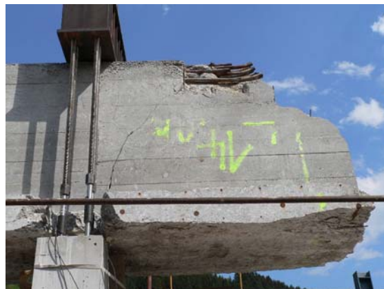
Abb. 2-5: Vorschädigung Träger Nr.1
