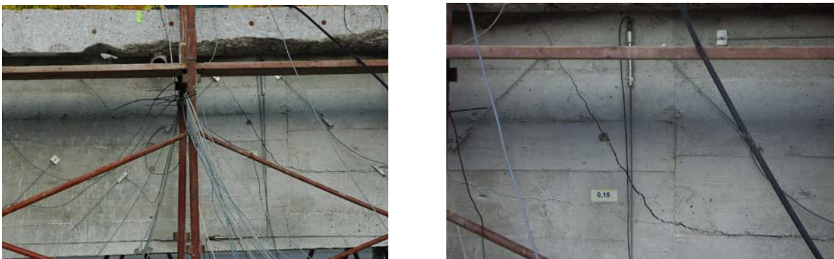
Abb. 8-18: Entstehung und Vergrößerung des Schubrisses unterhalb der Presse
