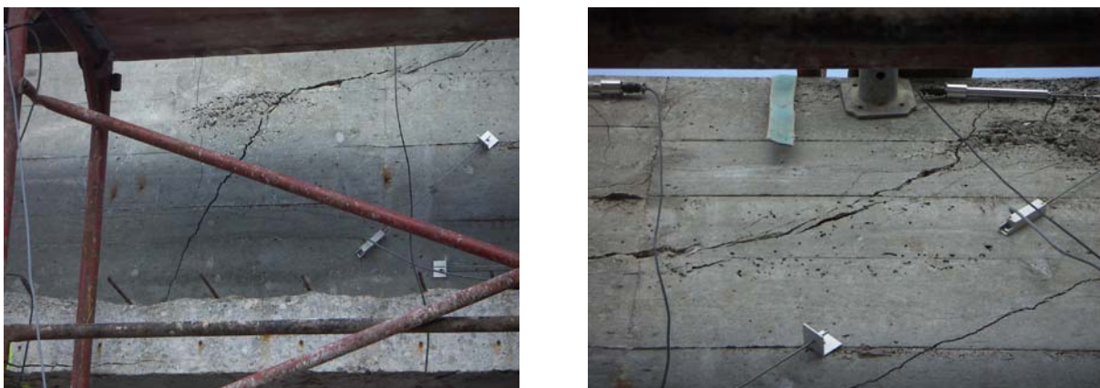
Abb. 8-19: Rissbild bei Höchstlast Träger Nr. 1
