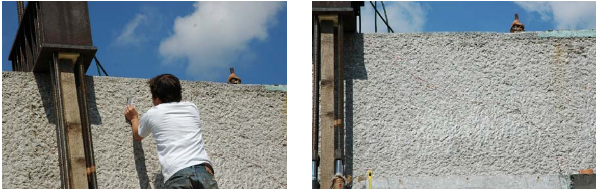
Abb. 8-16: Dokumentation des Rissbildes auf der gestuckten Trägerseite
