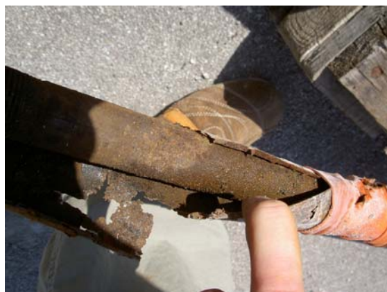
Abb. 2-10: Hüllrohr durchkorrodiert, Korrosionsnarben am Spannstahl
