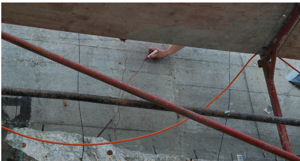
Abb. 4-5: Nachzeichnen der entstandenen Risse bei LS 6
