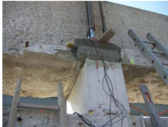
Abb. 3-11: Rissentstehung während Vorspannvorgang
