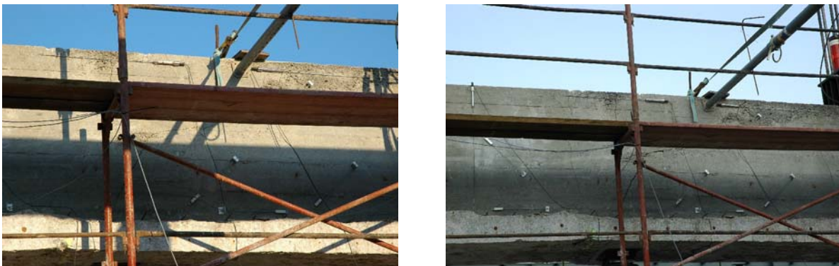
Abb. 8-17: Entstehung und Vergrößerung des Schubrisses oberhalb der Presse
