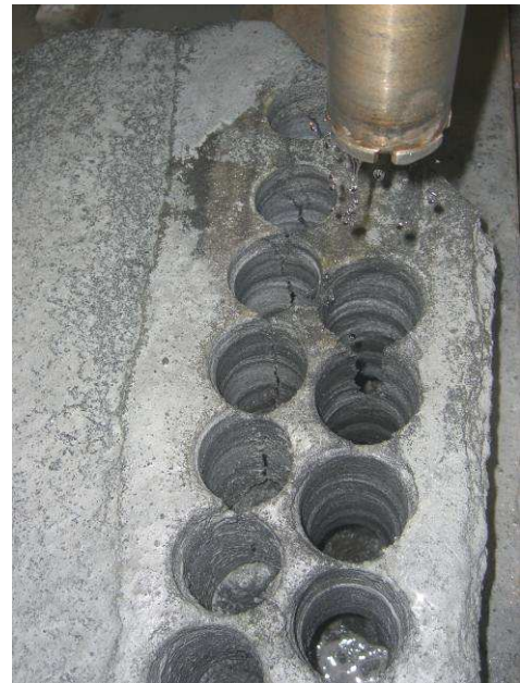
Abb. 60: Blick in die Bohrlöcher mit entstandenen Rissen
