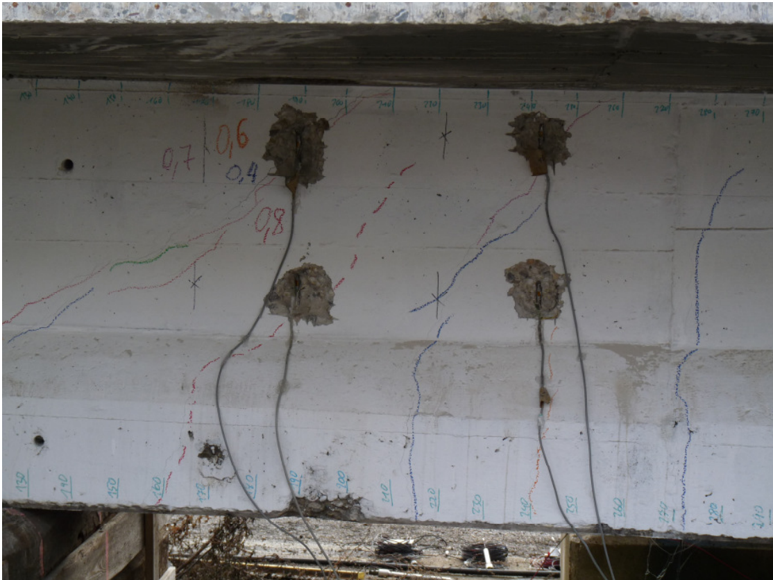
Abbildung 77: : Rissbild linke Seite – kein Riss bei DMS 4
