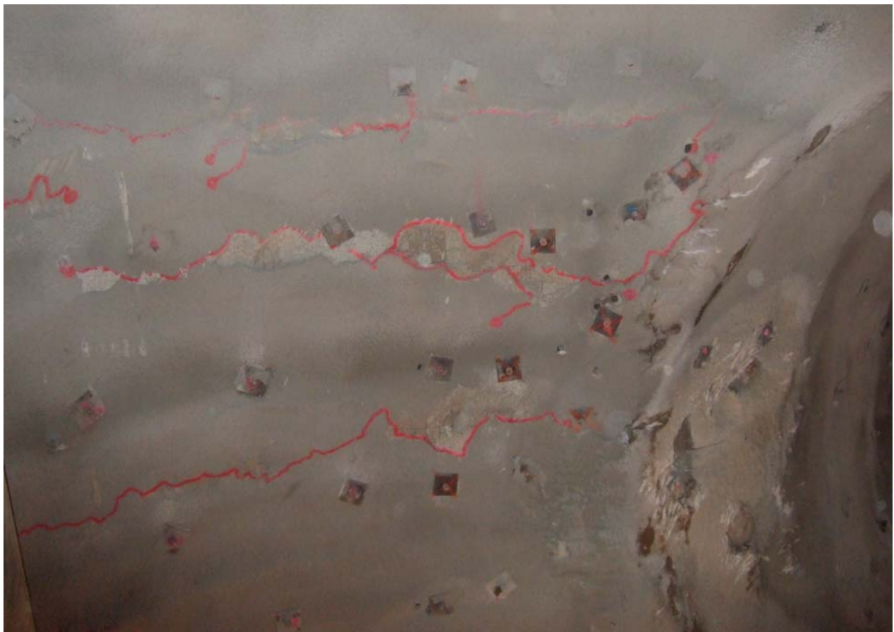
Abb. 1.4: Augenscheinlich Längsrisse im Kämpferbereich Nordulme / Querschlag (Station 333), 13.02.2007
