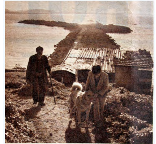
Abb. 11 Im Bau befindlicher West-Wellenbrecher; im Vordergrund der Leuchtturmwächter mit seinem Enkelsohn; Jahr 1960
