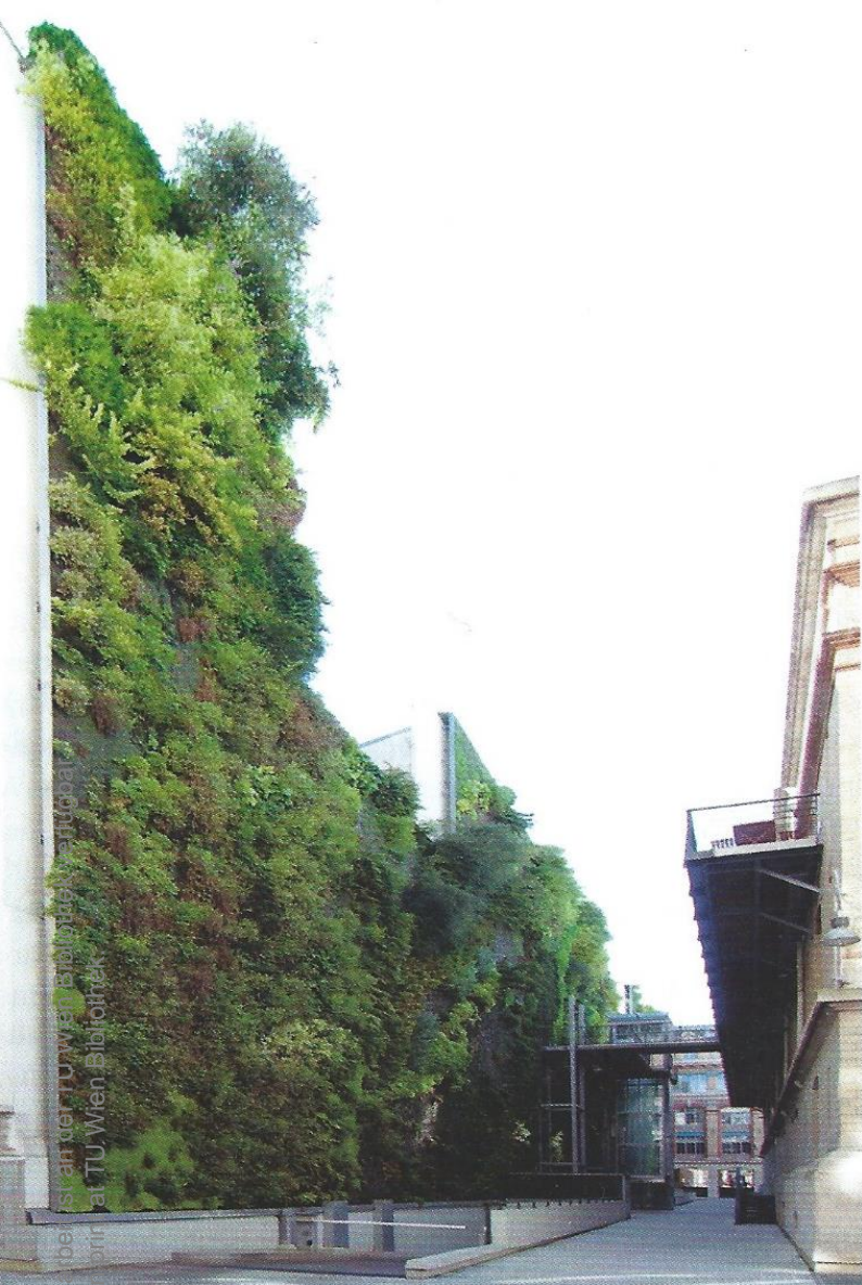
Abbildung 47: Wandgebundene Fassadenbegrünung: stellenweise Pflanzenausfall und sichtbar vernachlässigte Instandhaltung der Begrünung (Foto: Nicole Pfoser 2011)
