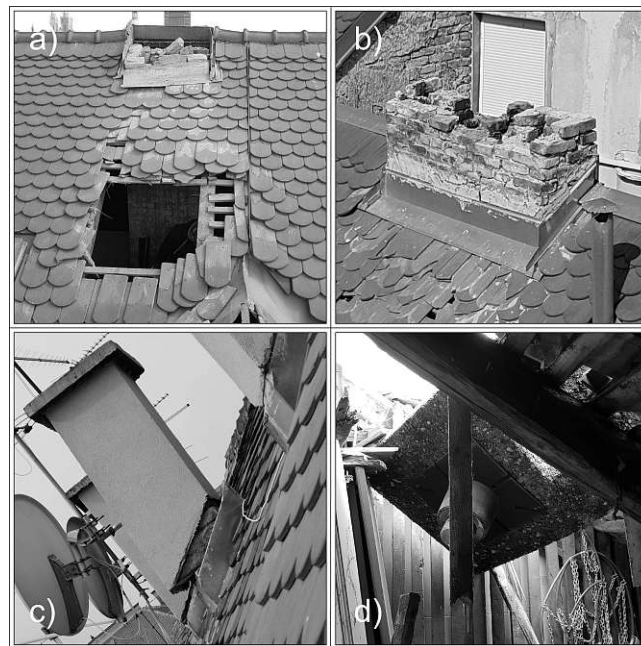
Bild 4.5: Charakteristische Erdbebenschäden an nichttragenden Bauelementen – gemauerte Schornsteine. Bilderquelle: [47] Grafik: A. Karic
