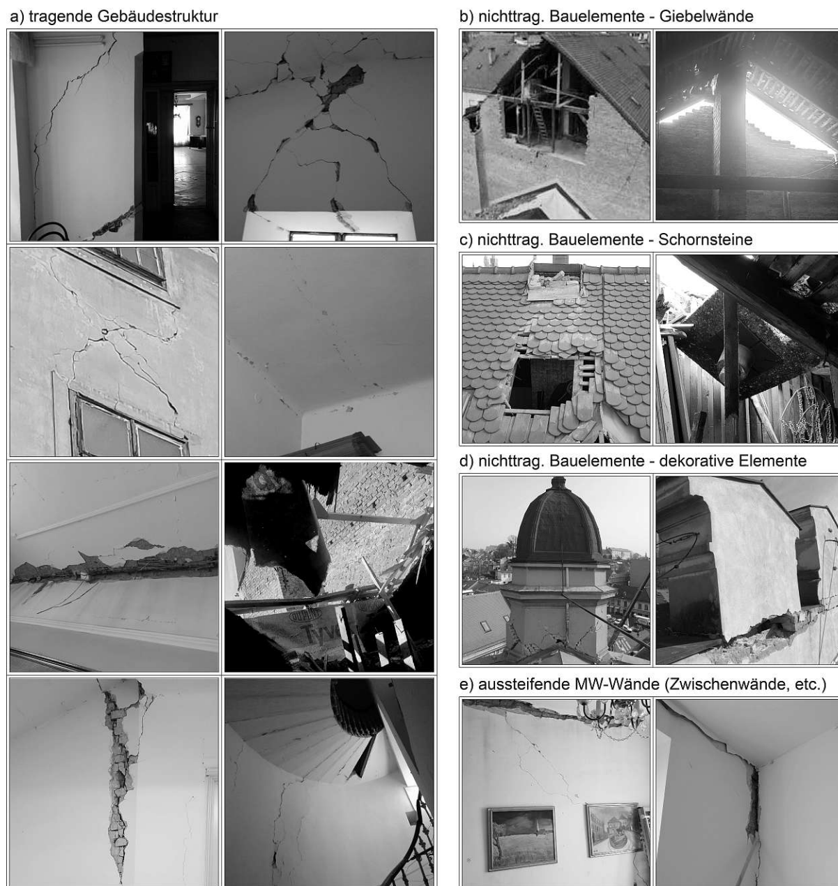
Bild 1.15: Erdbebenschäden an a) tragender gründerzeitlicher Gebäudestruktur, b) aussteifenden Mauerwerkswänden und nichttragenden Bauelementen, wie c) freistehenden, gemauerten Giebelwänden, d) gemauerten Schornsteinen und e) dekorativen Bauelementen nach [3].
