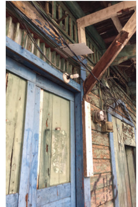
Abb. 100 - Detailsicht Zustand eines historischen Holzgebäudes in der Calle 17 Oeste [PS, 2019]
