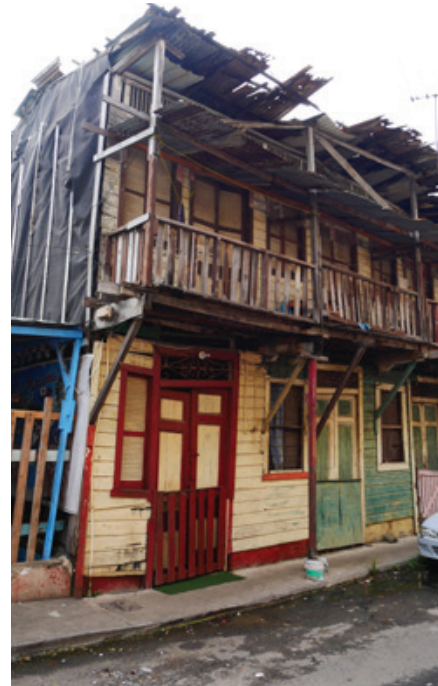
Abb. 101 - Detailsicht Zustand eines historischen Holzgebäudes in der Calle 15 Oeste [PS, 2019]
