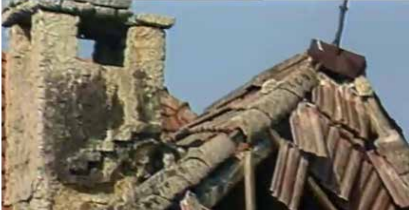
Abb. 29 Kaputtes Dach eines Biedermeierhauses im Salzburger Land
