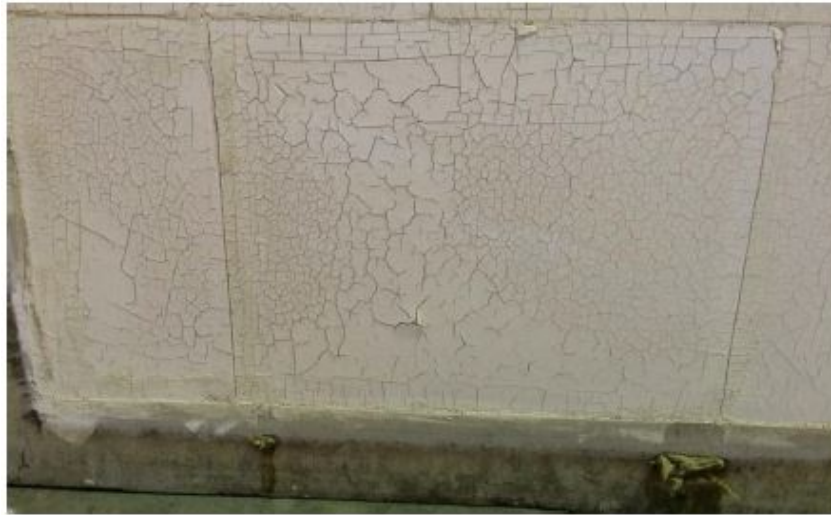
Abbildung 4.15: Risse an der Probekörper-Innenseite.
