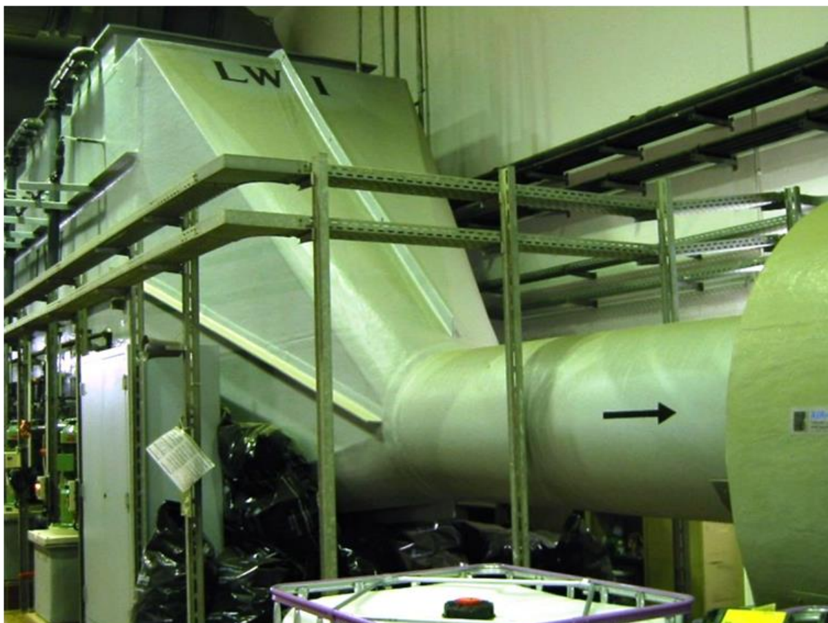
Abbildung 9: Chemischer Abluftwäscher, Kreuzstrom, Kläranlage Bonn
