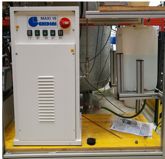
Abbildung 3.4: Dampferzeuger mit Speisewasserbehälter und Rückschlagventil
