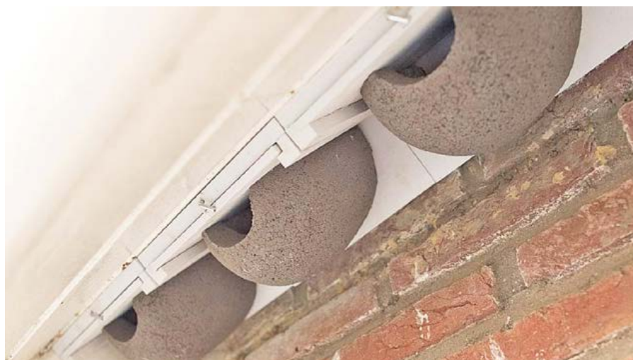
Abb. 301: Kunstnester für Mehlschwalben an einer Fassade
