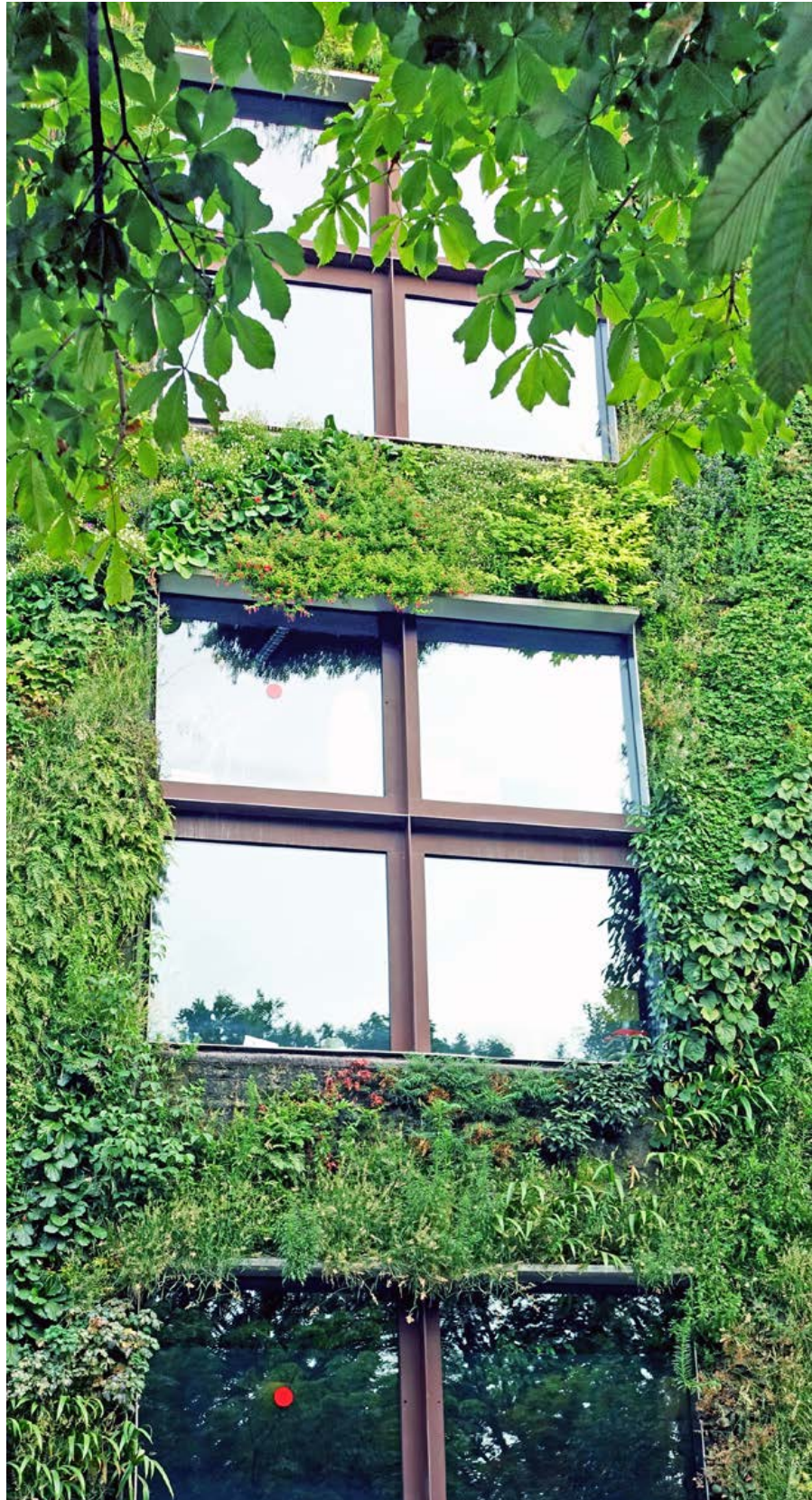
Abb. 163: Praxisbeispiel in Paris - Grünfassade beim Musée du quai Branly 100
