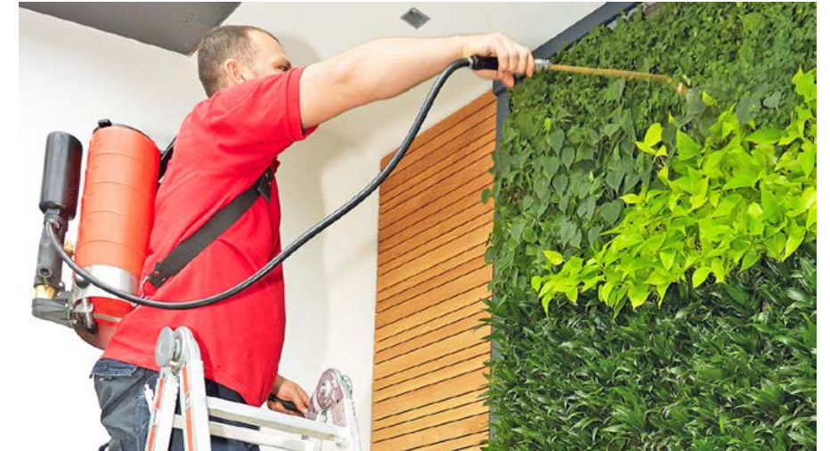
Abb. 160: Blattreinigung bei einer fassadengebundenen Innenraumbegrünung
