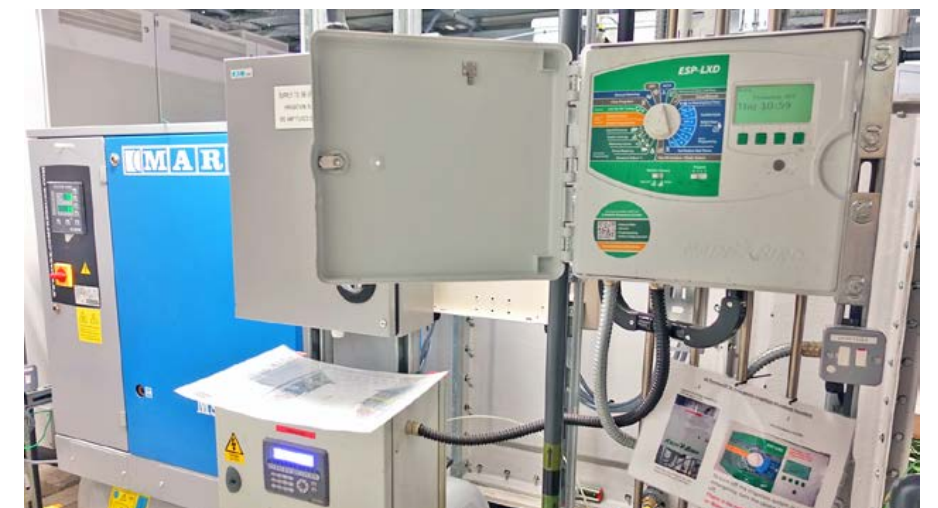
Abb. 254: Rain Bird Steuergerät für das Bewässerungssystem
