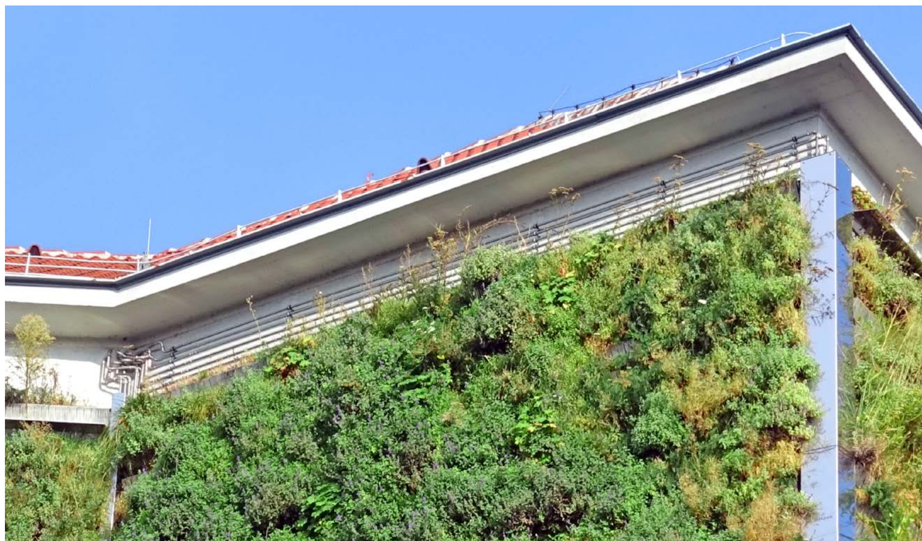
Abb. 266: Detailaufnahme - Wasserversorgung erfolgt über das Dachgeschoss
