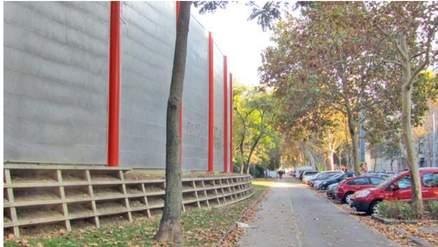
Abb. 307: Massive Schallschutzwand als Sichtbarriere
