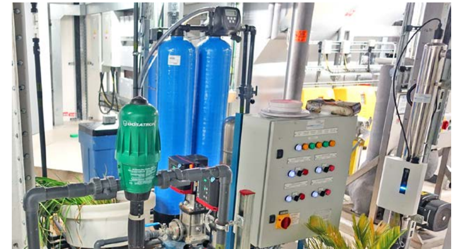
Abb. 253: Umkehrosmoseanlage zur Aufbereitung des Wassers
