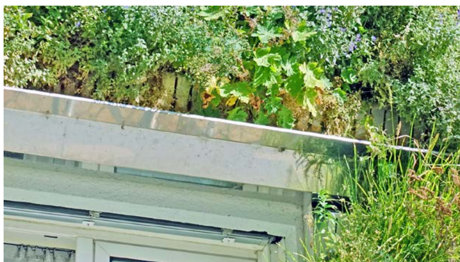
Abb. 336: Fassadenbegrünung der MA48 - Brandsperren aus Edelstahl
