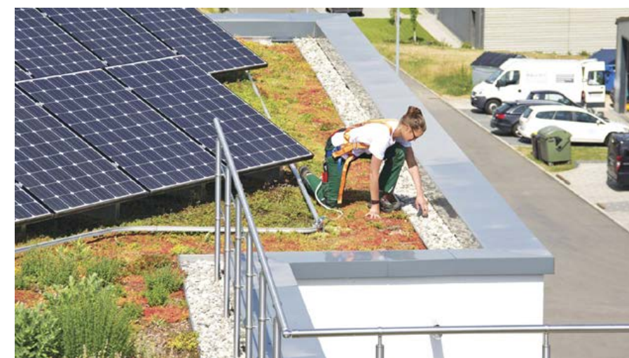
Abb. 73: Auflastgehaltene Solaraufständerung mit PV-Modulen und Absturzsicherung
