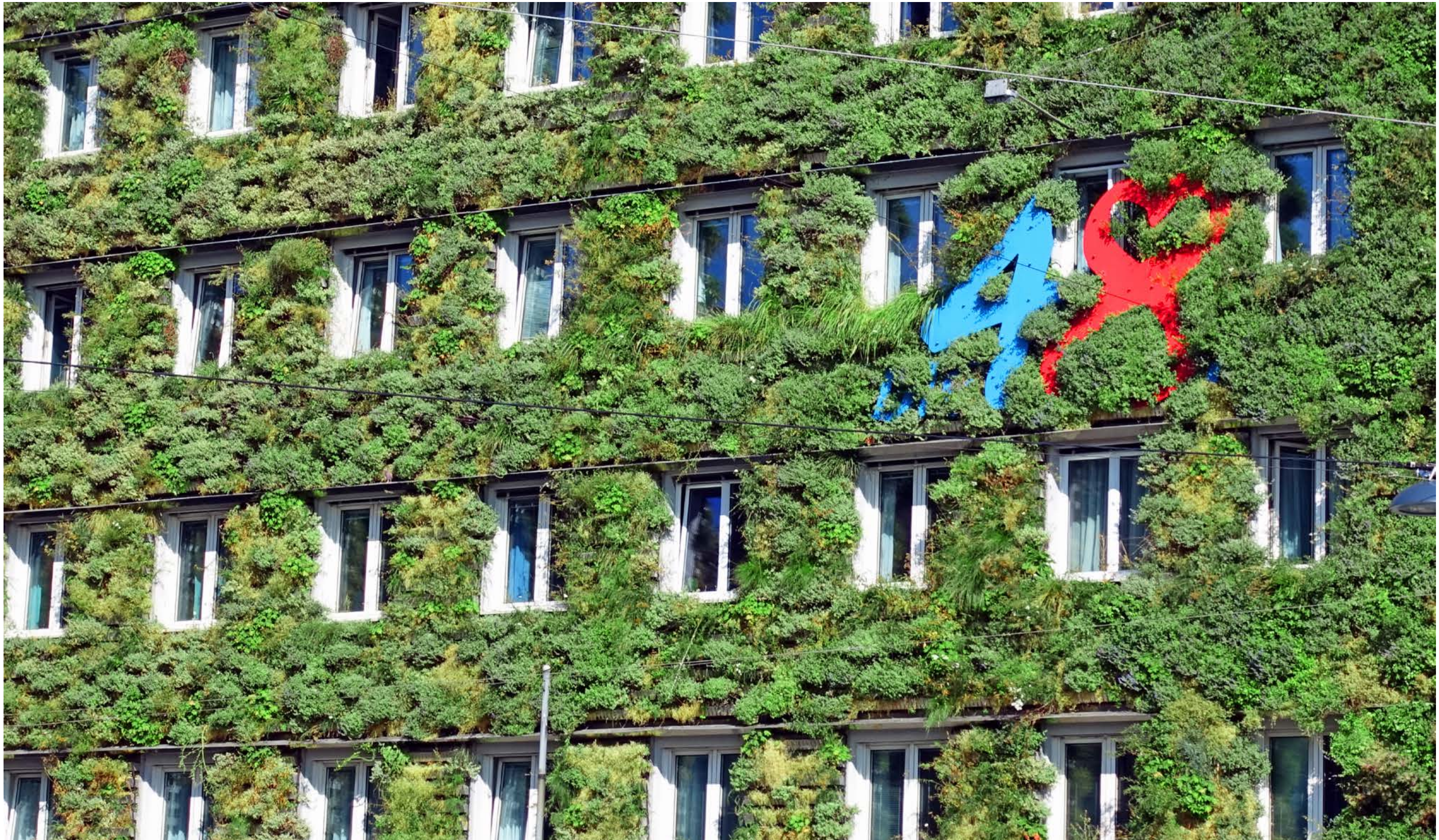
Abb. 257: Grünfassade bei der Zentrale der MA 48 - bei ihrer Errichtung im Jahr 2009 die größte Fassadenbegrünung in ganz Europa
