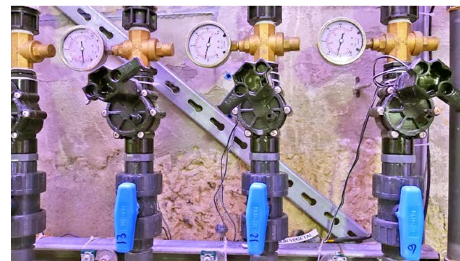
Abb. 227: Ventile mit Druckmanometern
