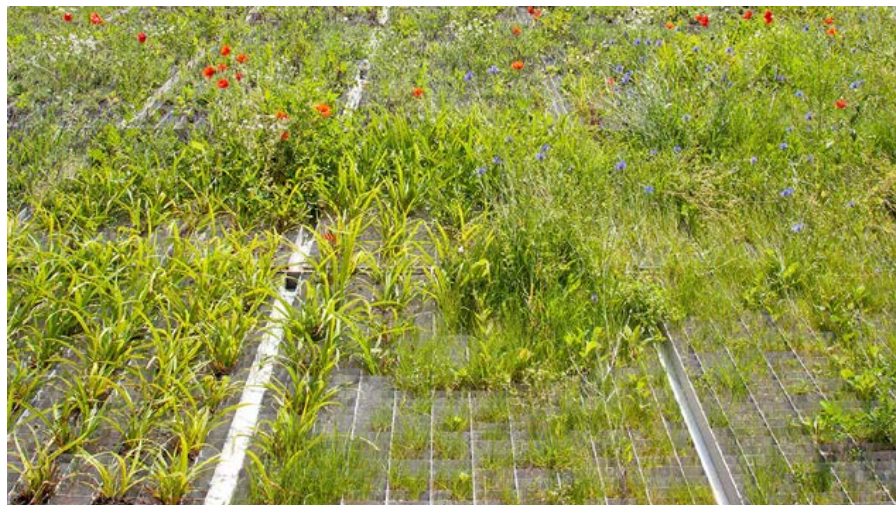
Abb. 107: Fassadenbegrünung mit vertikal angeordneten Modulen
