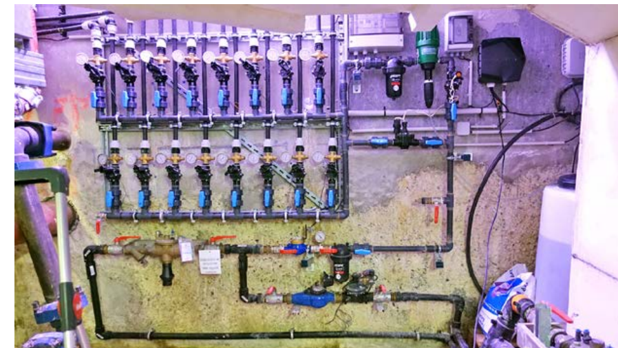
Abb. 225: Technikraum - Komponenten der automatischen Bewässerungsanlage
