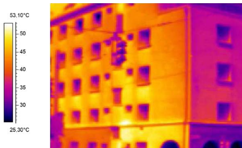
Abb. 42: Nachbargebäude ohne Begrünung - Oberflächentemperatur ca. 45°C (2011)
