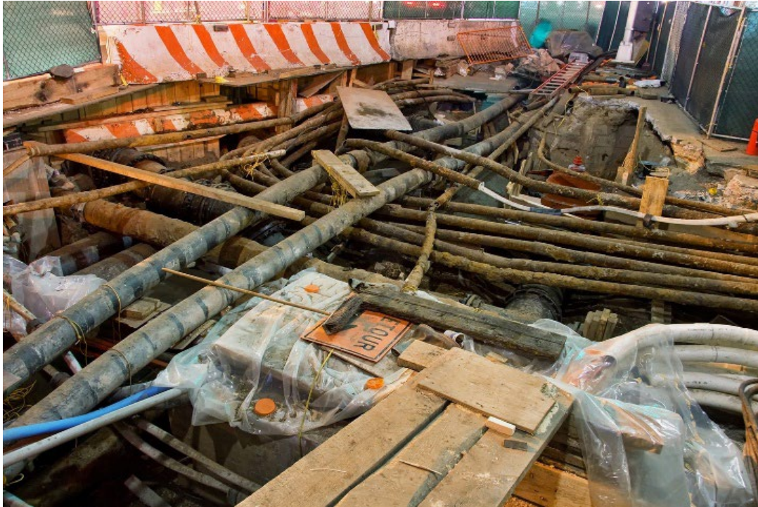
Abbildung 103: Ein Wirrwarr an Leitungen im Untergrund: Das Spaghetti-Subsurface-Problem. © Linda Bair
