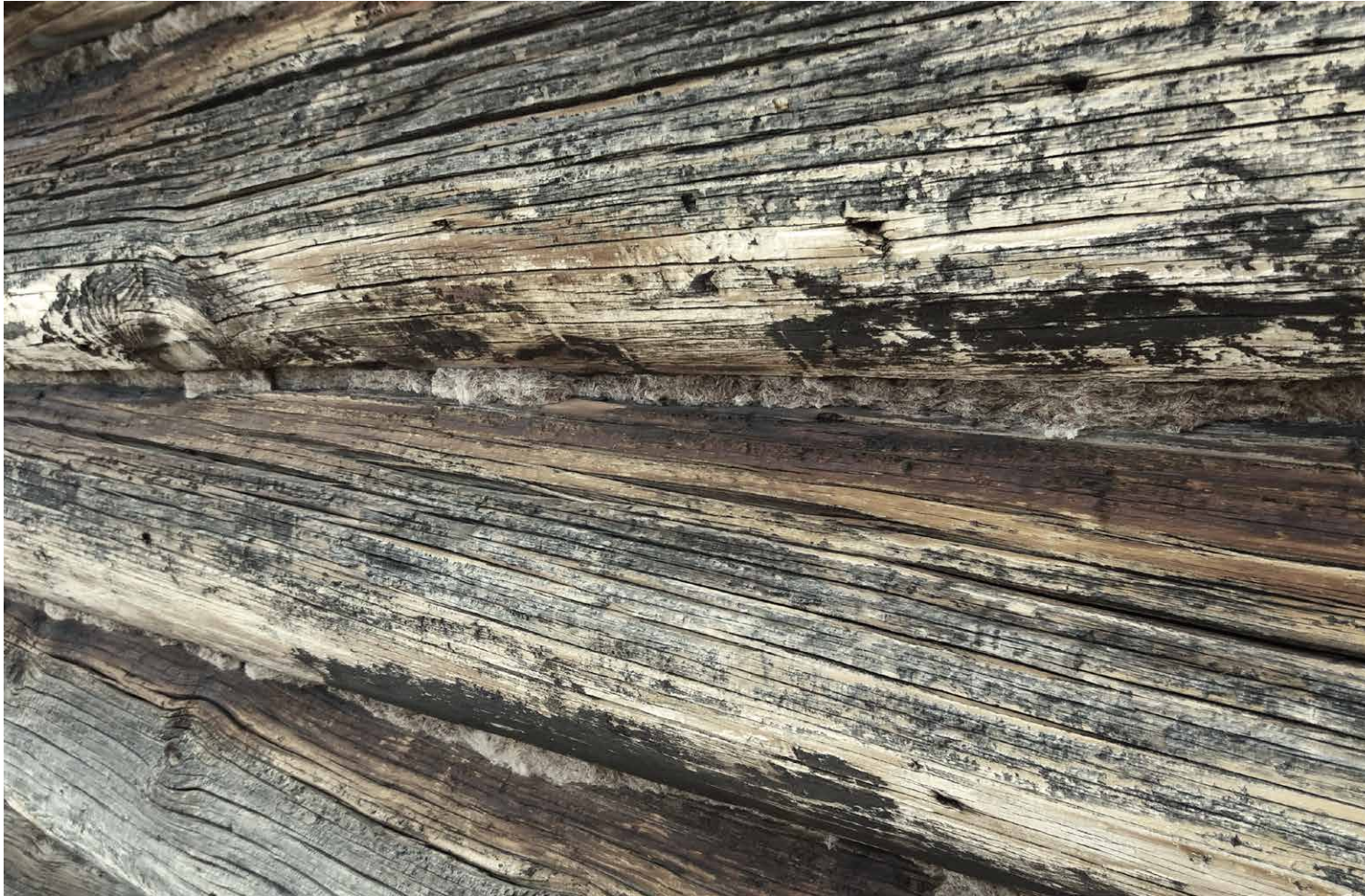
Links Abb.151: verwitterte und morsche Blockbauwand
