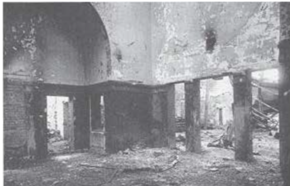
Abb. 80: Nach dem Bombenanschlag, Innen, 1945
