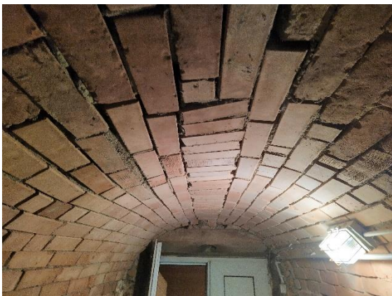
Abbildung 43: Bei diesem 1942 mit Zement vermörtelten Kellergewölbe musste der Firstbereich bereits erneuert werden; eigene Abbildung
