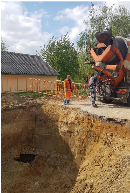
Abbildung 47: Das gestörte Bodengefüge wurde großzügig freigelegt um Setzungen nach der Sanierung zu vermeiden, Quelle: NÖ Straßendienst
