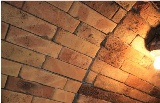
Abbildung 52: Übergangsbereich zwischen neuem und älterem Teil des Kellers in Martinsdorf, eigene Abbildung
