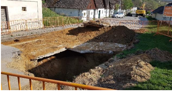
Abbildung 45: Der Hohlraum reicht bis unter die intakte Betonplatte, Quelle: NÖ Straßendienst
