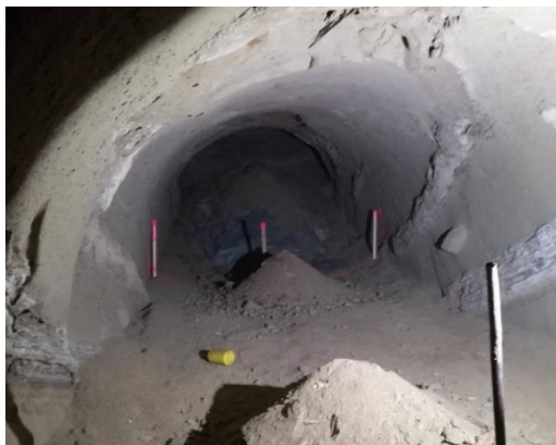
Abbildung 33: Keller ohne Ausbau mit Ausbrüchen im Firstbereich bei Fallbach, Quelle: NÖ Straßendienst
