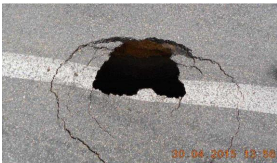
Abbildung 48: Fahrbahnschaden zufolge Kellereinbruch in Stronsdorf, Quelle: NÖ Straßendienst
