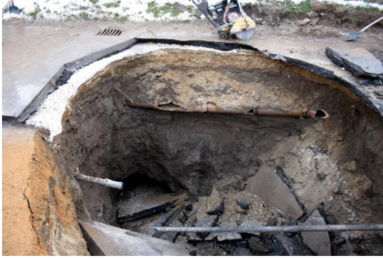
Abbildung 54: Mittig im Bild: die gebrochene Wasserleitung, links unten: das Loch in der Kellerröhre, Quelle: Martin Gotsch
