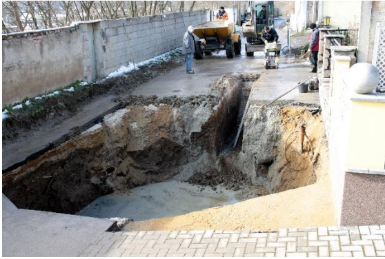
Abbildung 58: Kellereinsturz nach einem Wasserleitungsbruch in der Berggasse in Poysdorf 2015, Quelle: Martin Gotsch
