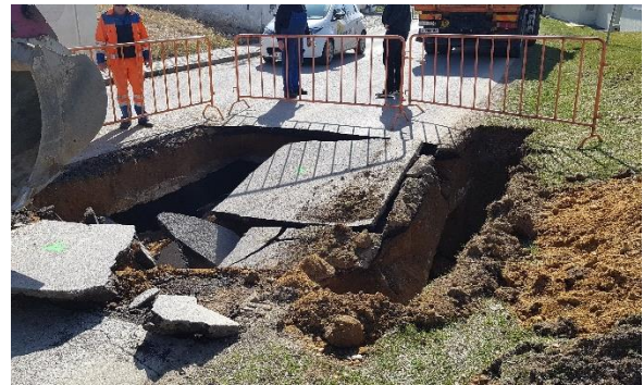
Abbildung 4: Einbruchstelle neben dem Sondierschlitz in Wultendorf. Quelle: NÖ Straßendienst
