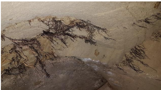
Abbildung 41: Einwuchs im Firstbereich, eigene Abbildung
