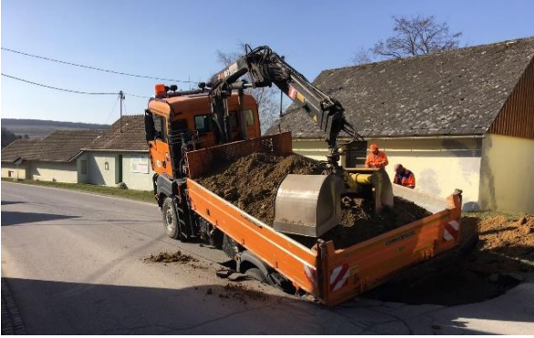
Abbildung 2: Kellereinsturz in Wultendorf, Quelle: NÖ Straßendienst
