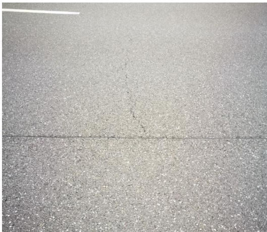
Abb. 6.6: Querriss bei km 47.406 auf Fahrstreifen 2, 2020
