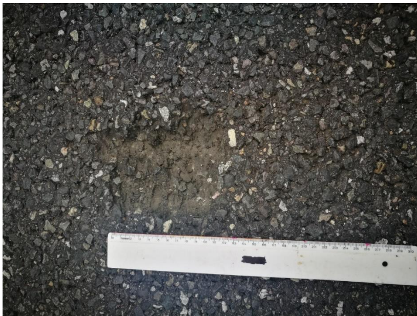
Abb. 6.5: Ausmagerungen am Fahrstreifen 1, 2020
