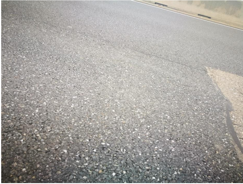
Abb. 6.4: Aufwölbung am Fahrstreifen 1, 2020
