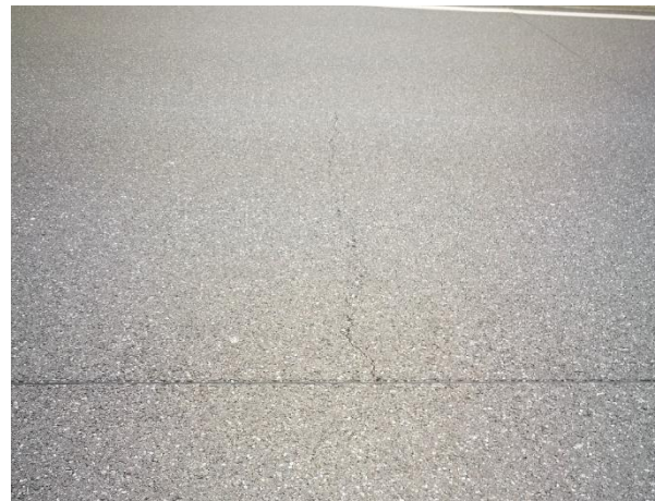
Abb. 6.7: Querriss bei km 47.428 auf Fahrstreifen 2, 2020
