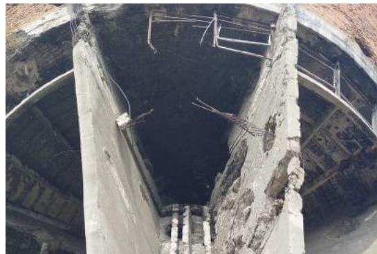
Abb. 30 - Schäden Wasserturm - durchgebrochene Decke
