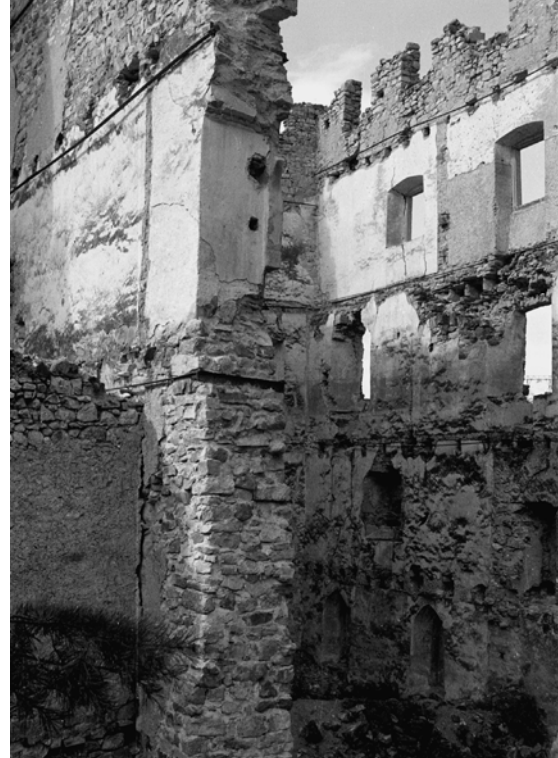
Abb.28: Abbruchstelle an der Trakttrennmauer
