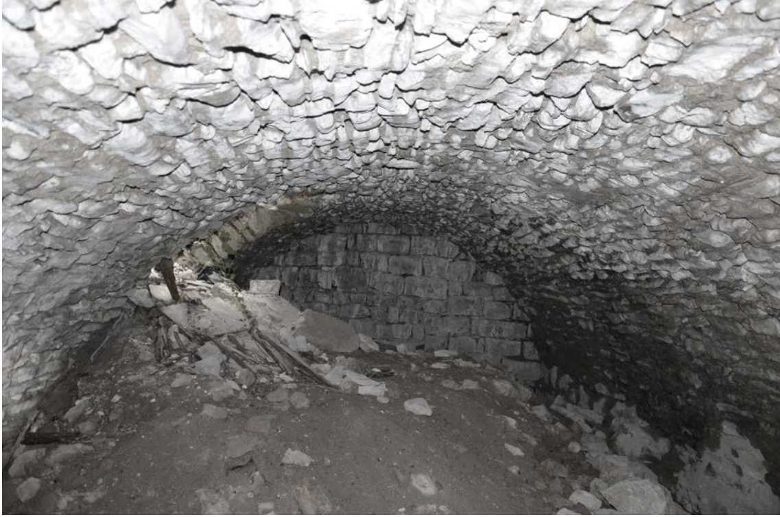
Abb.29: Kellergewölbe mit Zugang über Einsturzstelle
