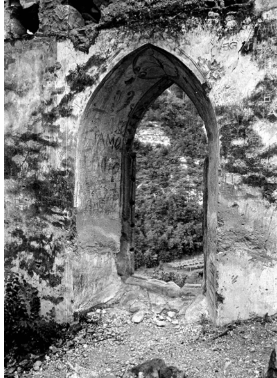
Abb.19: Kapellenfenster mit ausgebrochenem Maßwerk
