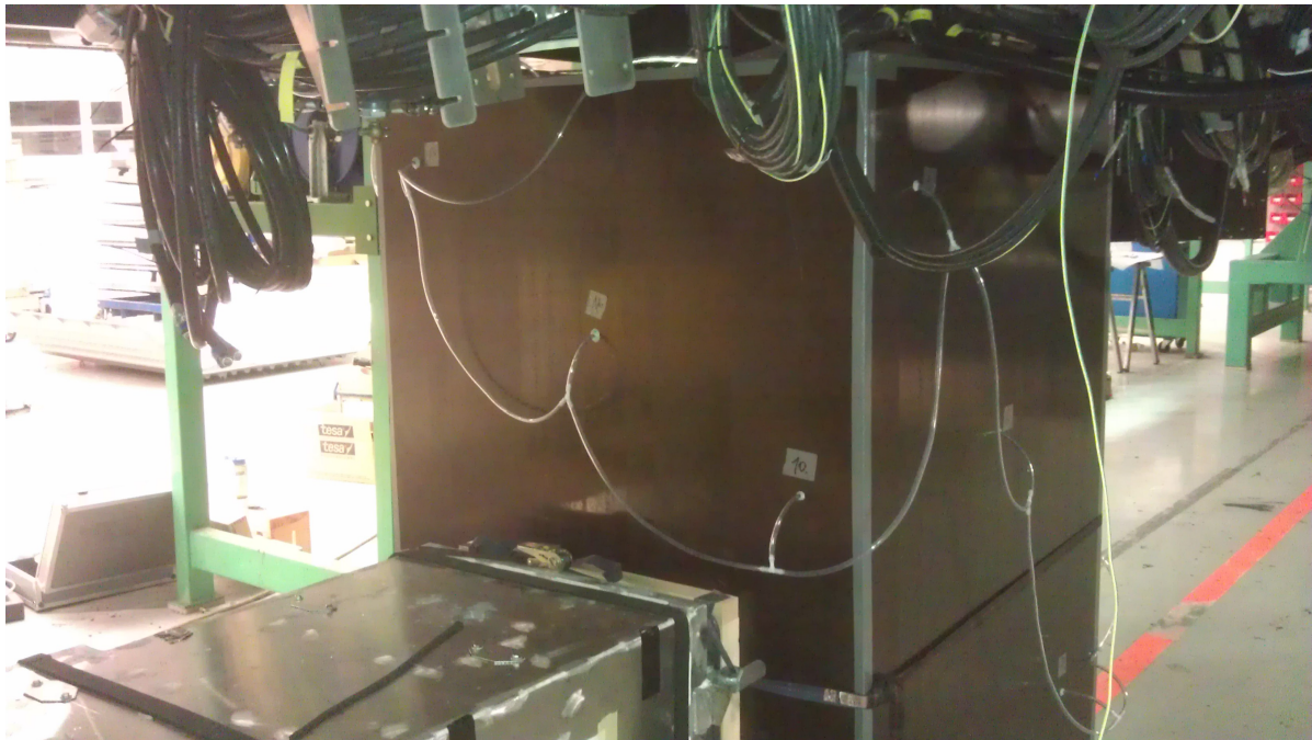
Abbildung 3.16: Fotografie der Adapterbox während der Messung des Lüftungskanals. Die Messbohrungen sind gut erkennbar.
