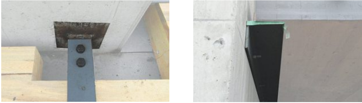
Abbildung 5: Verbaute Anschlüsse zum Kern und Dach
