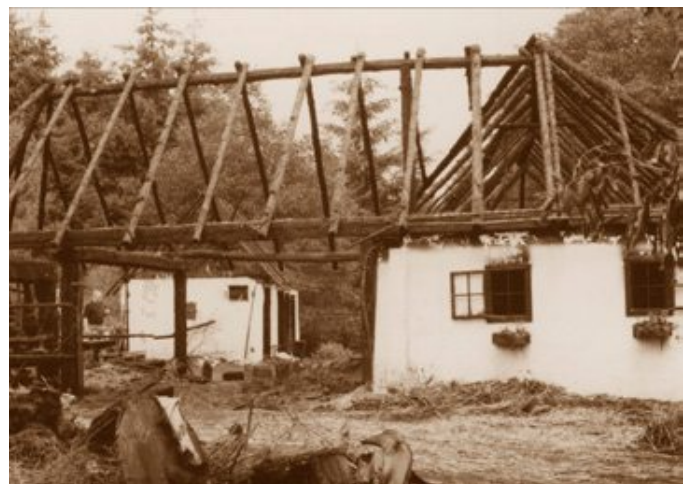
Abb. 99 | Zustand nach dem Brand
