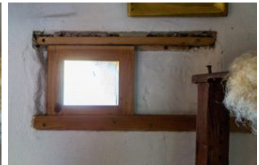
Abb. 77 | Fenster in der Kammer neben der Rauchküche Abb. 78 | Schiebefenster in der Stube (geöffnet)
