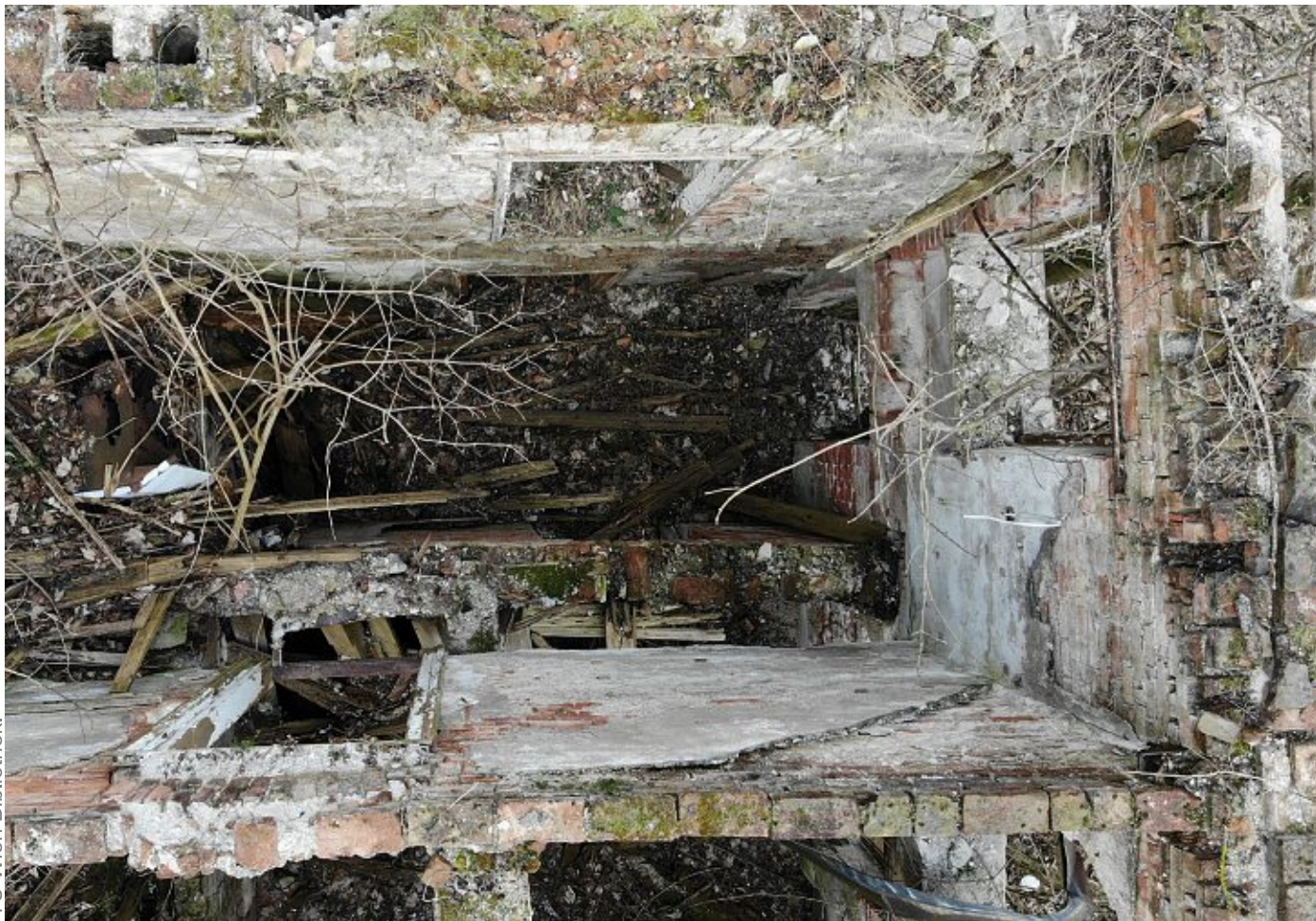
Abb. 29 Ruine von der Mühle am Hof №4, Innenraum / Drohneaufnahme
