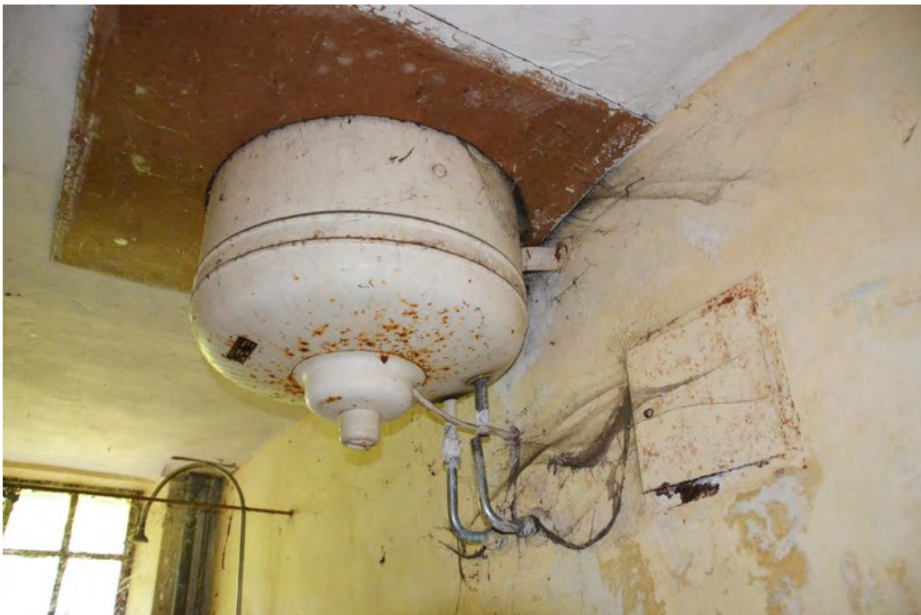
Abb. 144: Decke und Wand W-E3.C., Warmwasserspeicher bzw. Boiler und Verteilerkasten, Mai 2020
