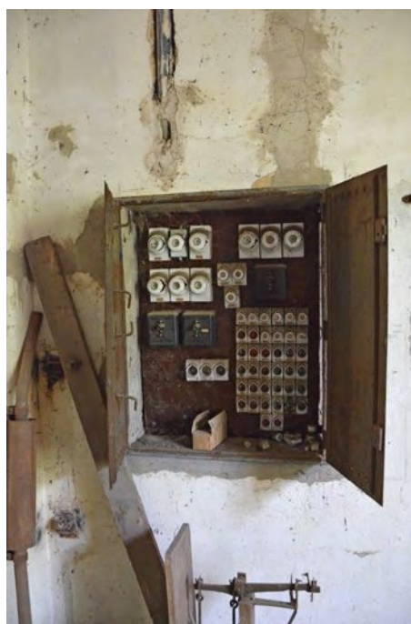
Abb. 129: Wand W-E1.E, Verteilerkasten, Mai 2020
