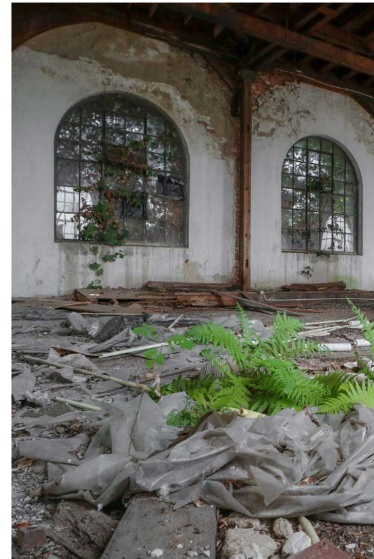
Abb. 6.40 Farne im 4.OG des Mehlspeichers
