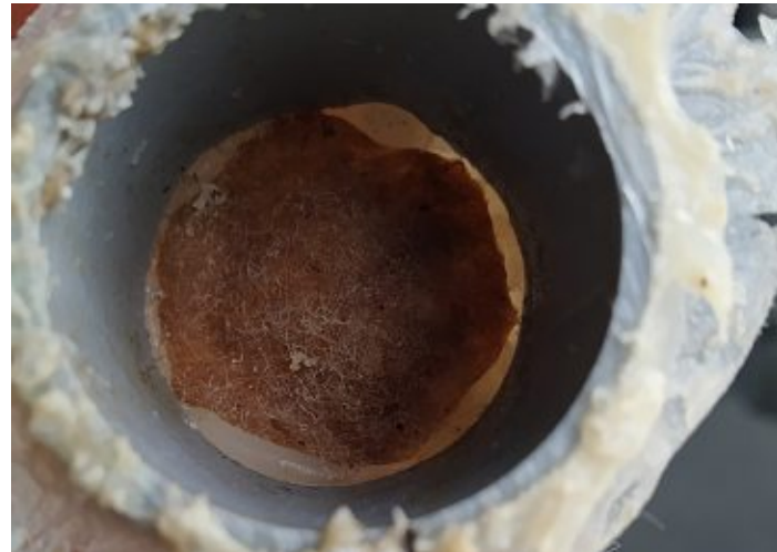
Abb. 85: das alte Verbinderstück war ein zersägtes Rohr
