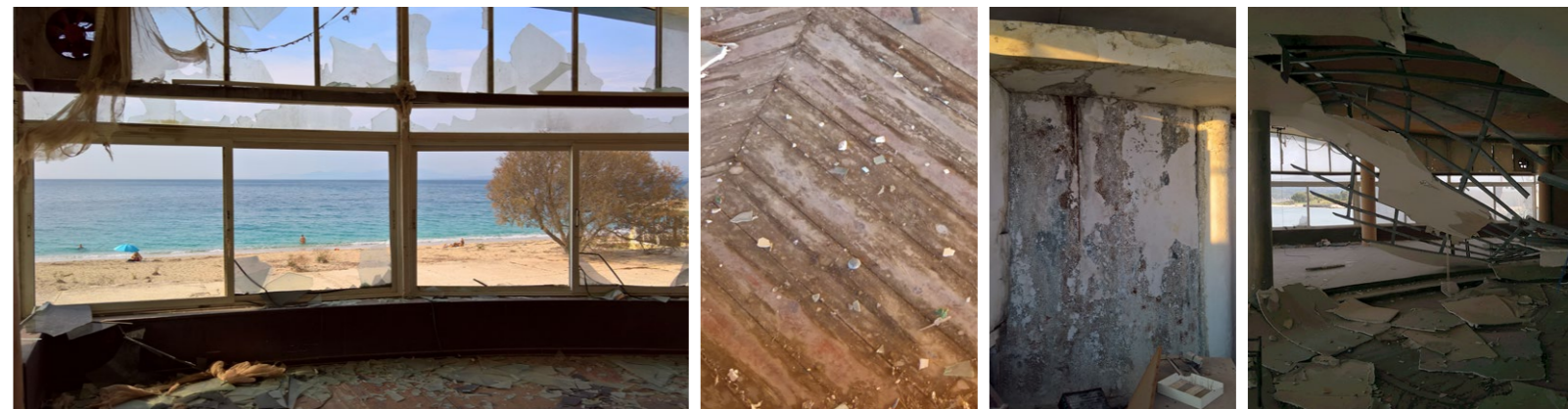
v Abb.152: Beschädigtes Panoramafenster, Abb.153: Holzboden, Abb.154: Schäden durch Feuchtigkeit, Abb.155: Decke über Tanzfläche
