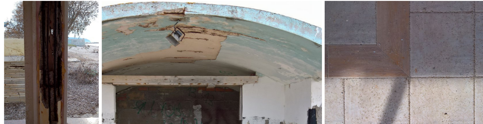
v Abb.146: Beschädigte Stütze, Abb.147: Korrosionbeschädigtes Betonschalendach, Abb.148: verfliester Boden im neuen Gastraumbereich
