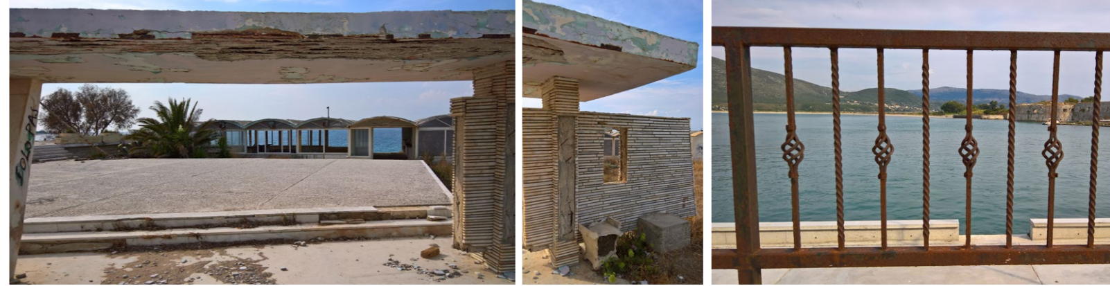
^ Abb.143, Abb.144: Schäden im Eingangsportal, Abb.145: Terrassengeländer
