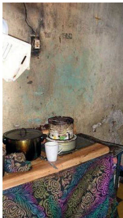
[242] Schädigung der Bausubstanz durch Kochstelle im Wohnraum
