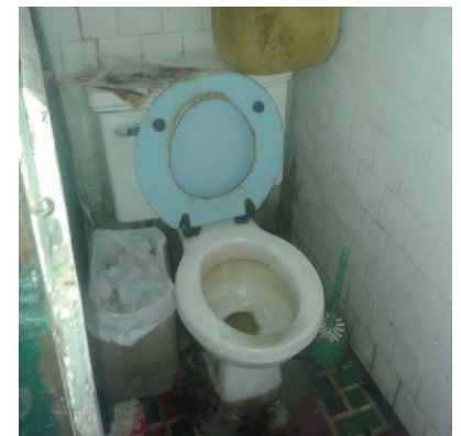
[175] WC in katastrophalen hygienischen Zustand
