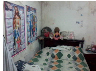
[241] Zimmer in mangelhaftem Zustand mit feuchten Wänden und Schimmelbildung
