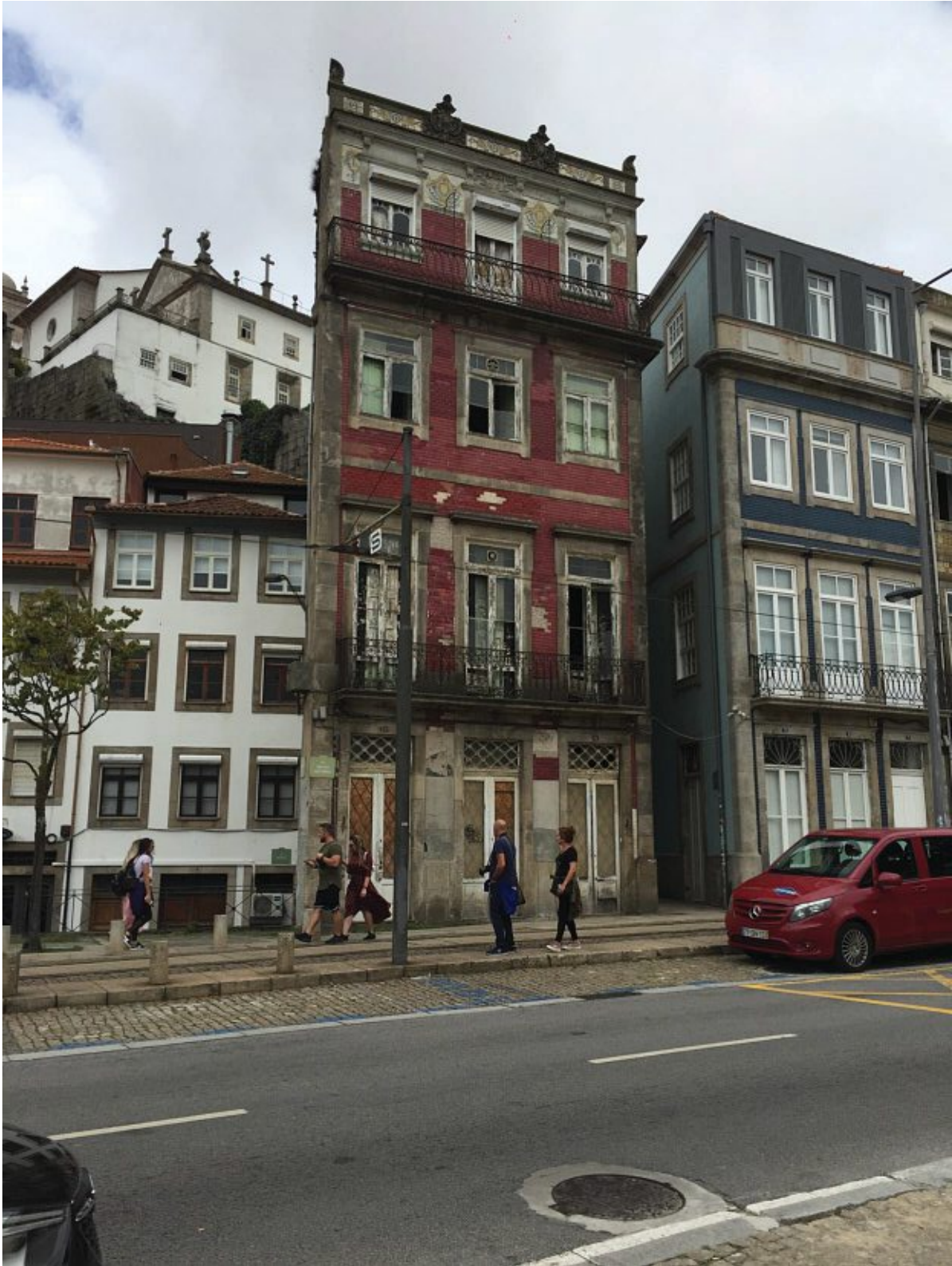
Abbildung 38 Haus fortgeschrittener Degradierung
