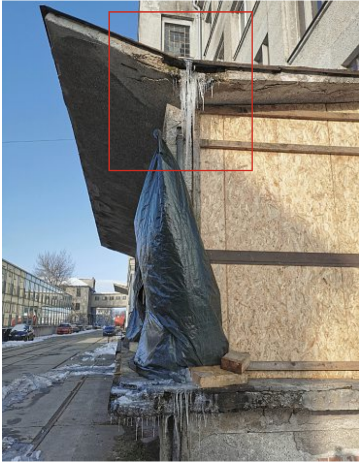
Abb.67: Die schadhafte, innenliegende Entwässerung eines Betonvorsprungs an der Zurichte I, die Eisbildung führt zum Abplatzen der Betondeckschicht und zur Freilegung der Bewehrung.
