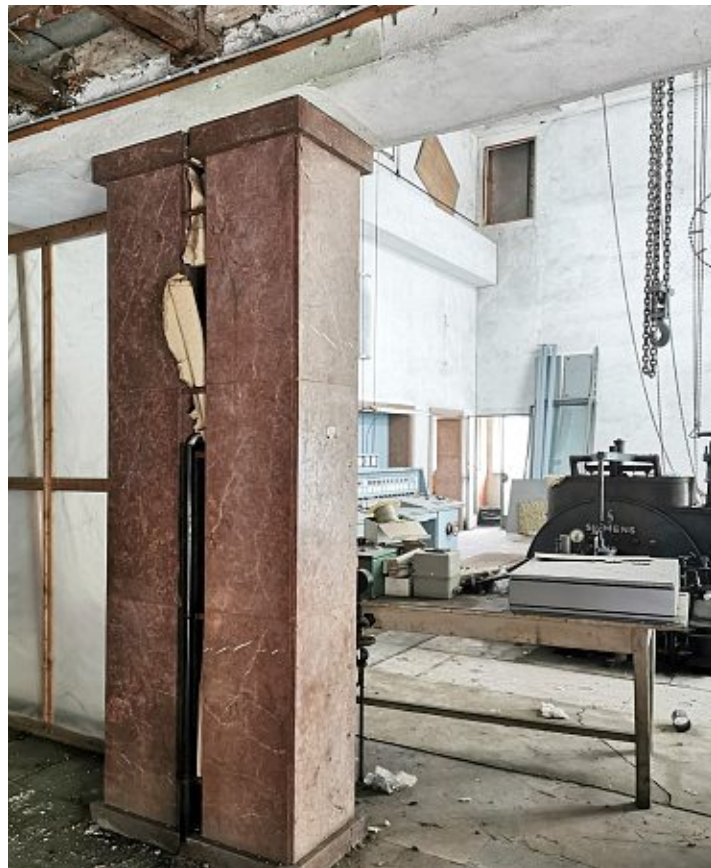
Abb.59: Eine marmorverkleidete Stütze im neuen Turbinenhaus. Im Hintergrund der erhaltene Schalttisch und eine Turbine. Dieses Gebäude war das Herzstück der Fabrik, das ist auch an der hochwertigen Innenaustattung zu erkennen.
