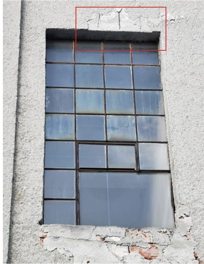
Abb.68: Freigelegte Bewehrung im Bereich des Fenstersturzes an der Zurichte II.
