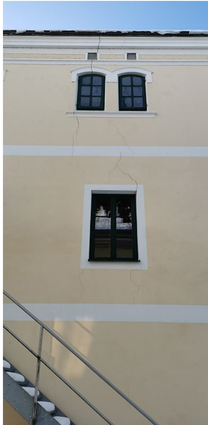
Abb.66: Risse an der Fassade der alten Wasserwerkstatt – Feuerwehrdepot aufgrund von Setzung.
