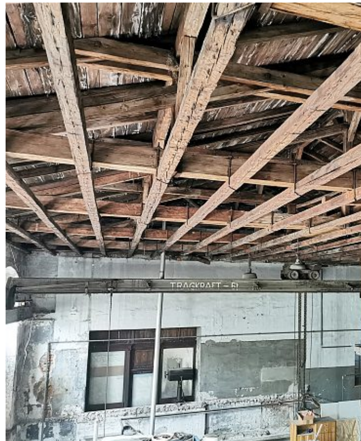
Abb.60: Der Innenraum des alten Maschinenhauses. Die Gerätschaften wurden weitgehend ausgebaut, an den Decken befinden sich noch die Lastenkräne. Im Bereich der Dachlattung sind Feuchteschäden erkennbar, die Balken scheinen nicht betroffen.
