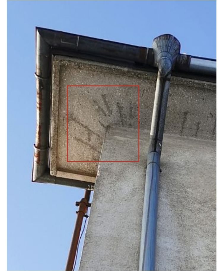
Abb.69: Unzureichende Betonüberdeckung an der Unterseite des Dachvorsprungs am neuen Turbinenhaus.
