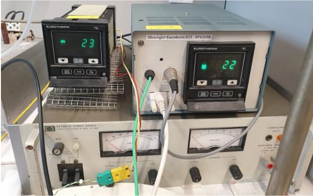
Abbildung 24: System zur Ofenbeheizung
