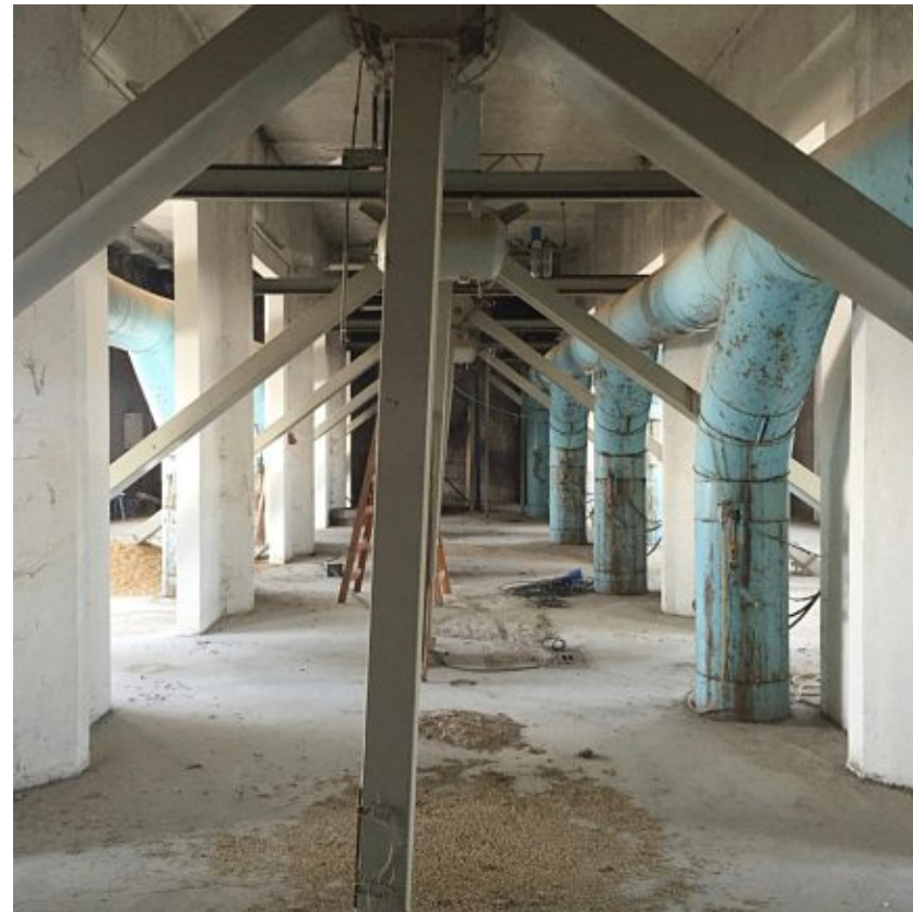
Abb. 56: Verteiler im Nordturm
