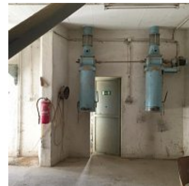
Abb. 58: Abfüllanlage im Südturm
