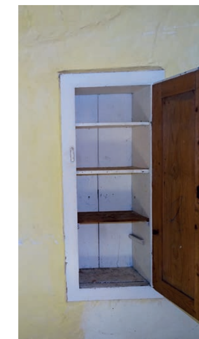
ABB. 255 ◀◀◀ Eingangstür in das Turmzim- mer; Risse ersichtlich entlang der ehemaligen Öffnung.
