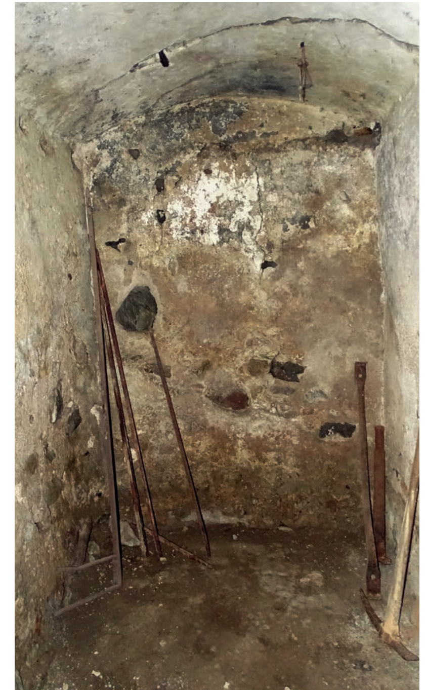
ABB. 190 ▲ Eingang des Kellerraumes KG.01: Die ehemalige Öff- nung ist noch gut erkennbar.
