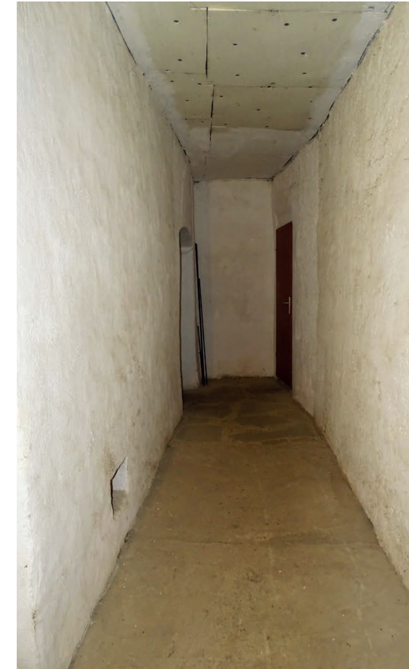
ABB. 237 ◀ Abplatzungen des Putzes und des Anstriches im Bereich der Eingangstür.
