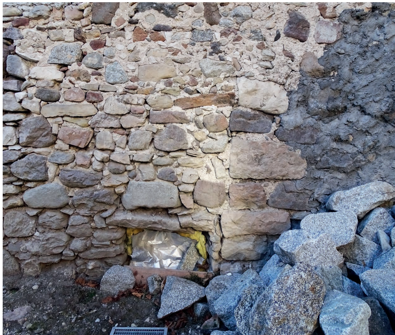
ABB. 107 ◀ Baufuge an der Nordfassa- de zwischen der 2. und 3. Bauphase.
