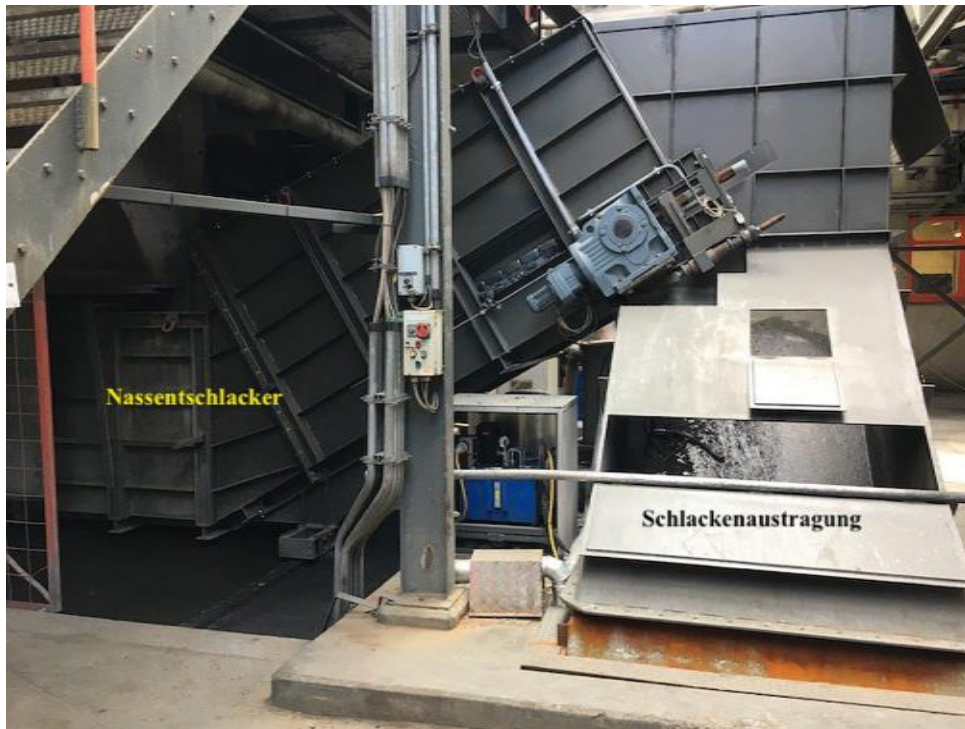
Abbildung 6: Blick auf die Schlackenaustragung. Der Nassentschlacker kühlt die heiße Asche rasch ab und ermöglicht eine mechanische Austragung
