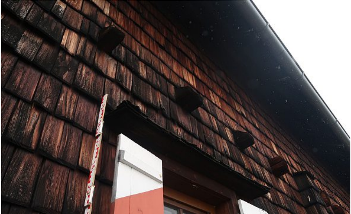
Abb. 43: Unverkleidete Balkenköpfe entlang der Ostfassade auf Höhe der Decke über dem Erdgeschoss, 2020
