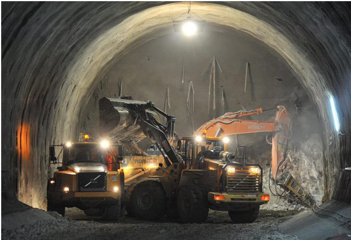
Abb. 2.8: Das Beladen eines Muldenkippers während des Vortriebs (Quelle: Route One Publishing Ltd. [60])
