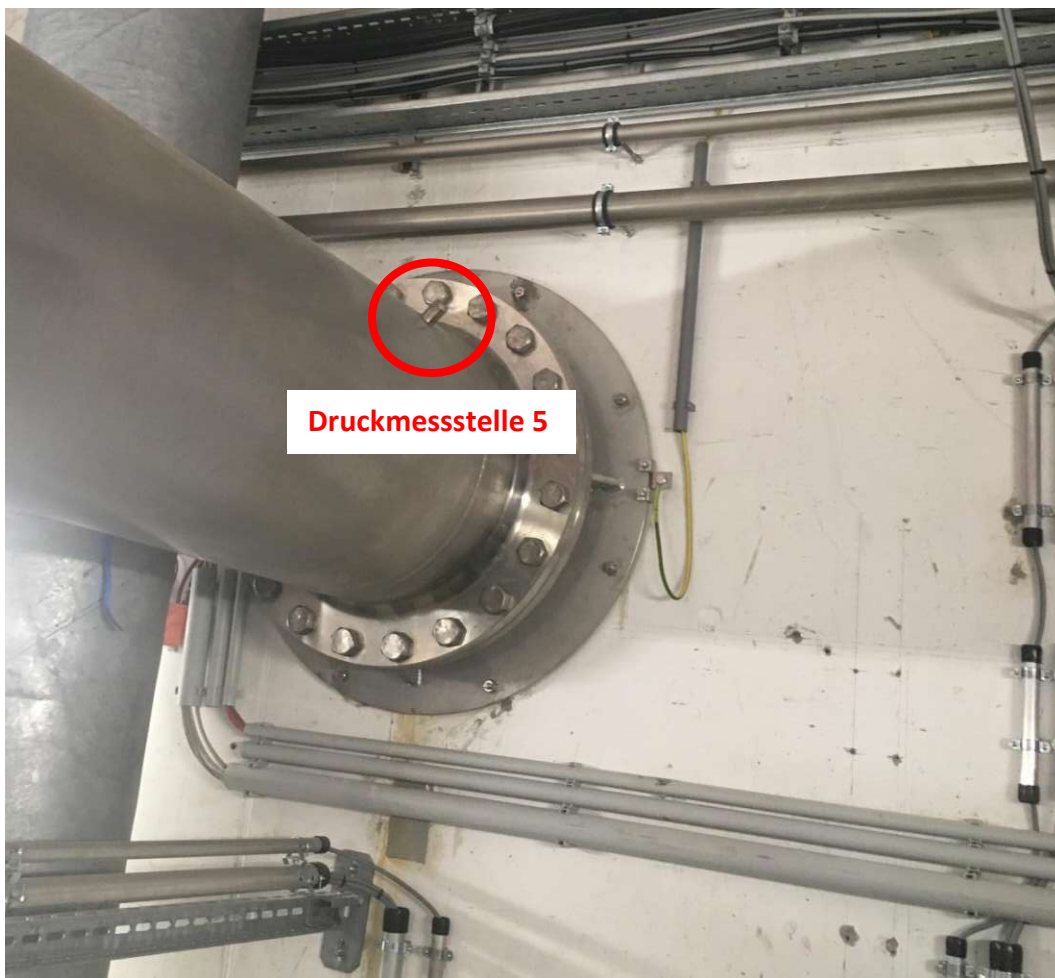
Abbildung 16: Druckmessstelle 5 in der Pumpengrube im Rohrleitungssystem des Universalversuchsstandes
