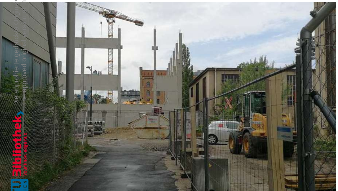
Abb. 046 Arsenal: Bauarbeiten für die Wasserbauhalle am ehemaligen Standort des Objekt 219, Mai 2019 © Anne Altmeyer
