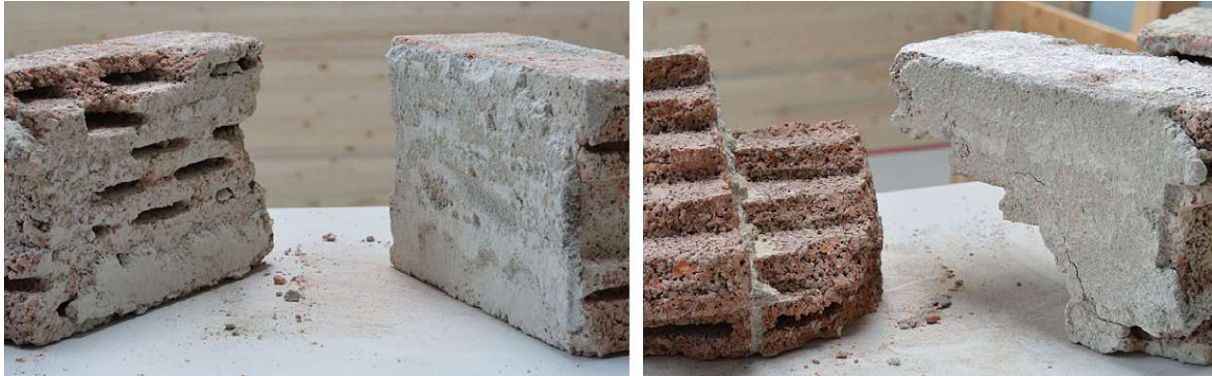
Abb. 5.36: Exemplarische Darstellung des Prüfkörpers mit Versagen durch Schubbruch (links) und mit zusätzlichem Versagen durch Zerschlagen des Mauersteins (rechts)
