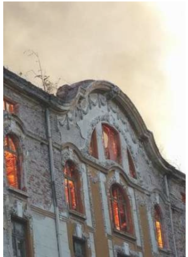
Abb. 33 Lagerhäuser von Kudoglu während dem Brand 2018
